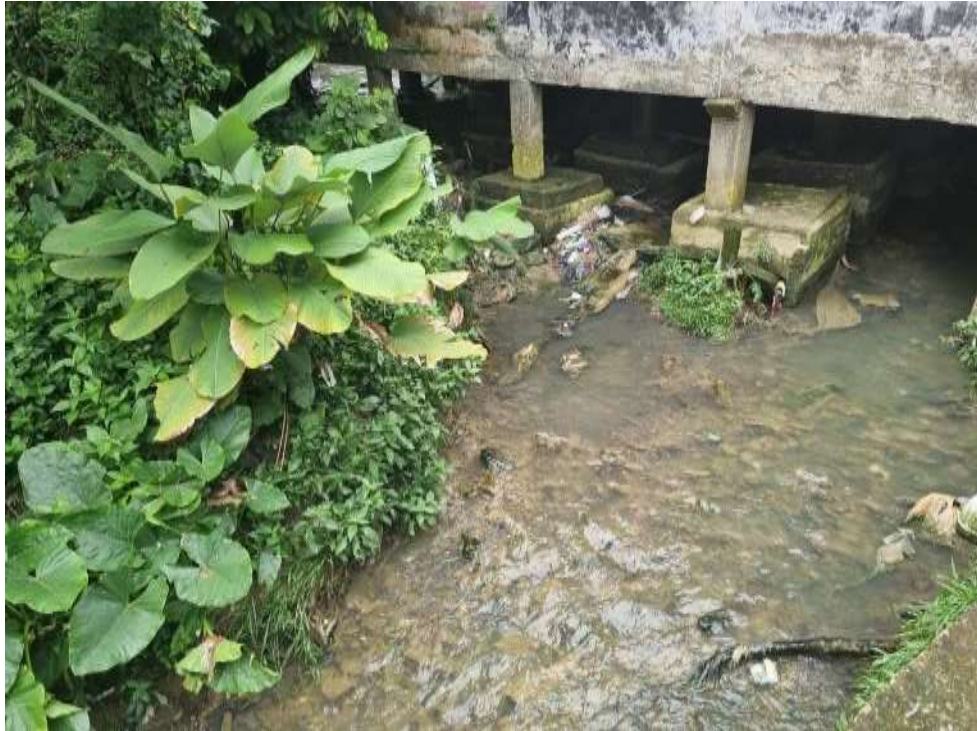
Ilustración 11. Barrio independencia, vivienda construida sobre la quebrada.
