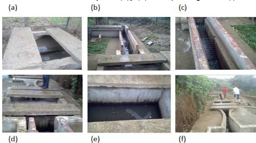
Figura 3-3: Estructuras de la PTAR Chinavita (a) Rebosadero de excesos, (b) y (c) Canal de entrada con rejillas, (d) y (e) Trampa de grasas, (f) Canaleta Parshall
