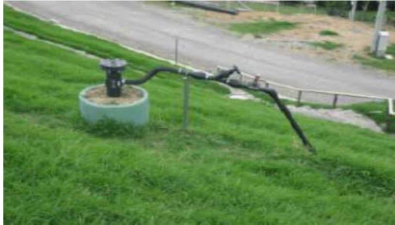
Figura 8. Conector de gas y pozos de desfogue sistemas de drenaje activo relleno sanitario Antanas, Pasto, 2012.
