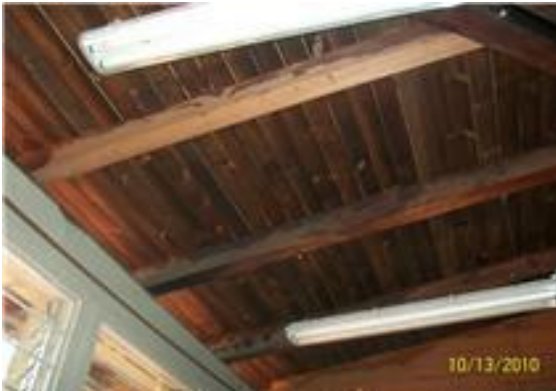
Techo de mi oficina deteriorado
