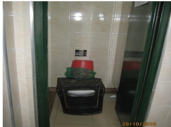
Baño público deteriorado
