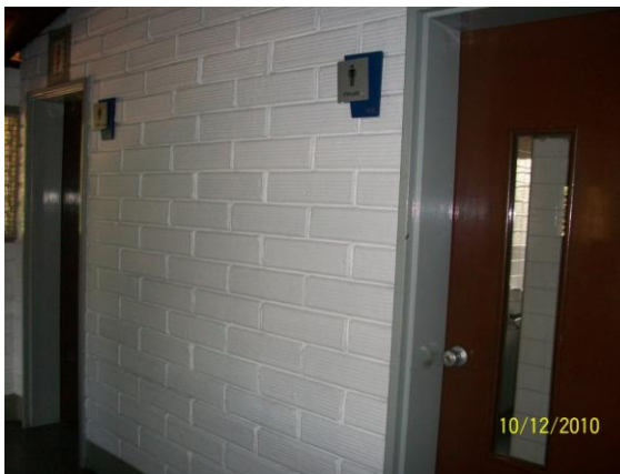
Baño cerrado por deterioro
