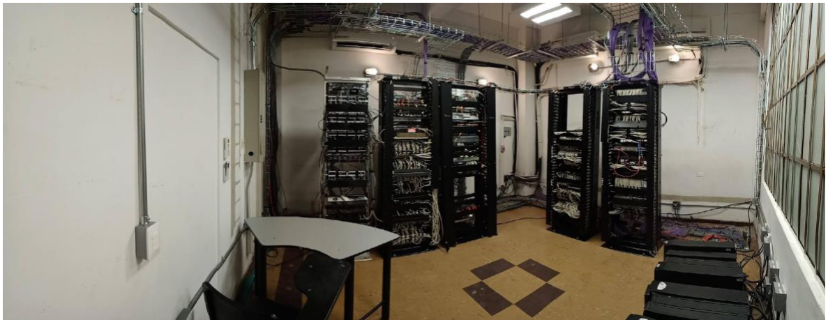
Imagen Numero 3: Panorámica Centro de cableado universidad de Manizales [Citado: 25/09/2021].
