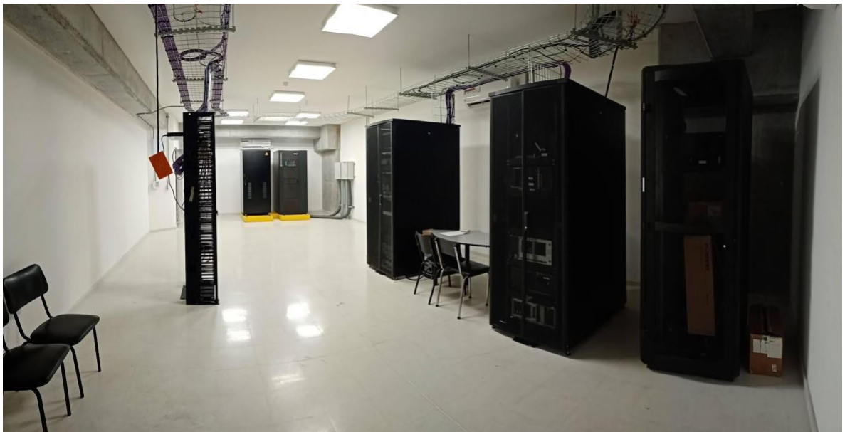
Imagen Numero 5: Panoramica Centro de cableado torre emblematica universidad de Manizales [Citado: 25/09/2021].
