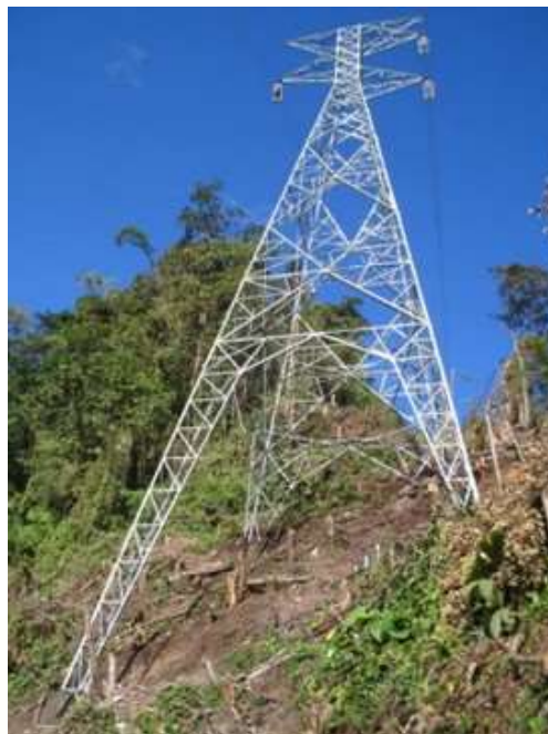
Figura 25 Construcción de Torres y Líneas de Transmisión Eléctrica dentro de la Reserva Forestal.
