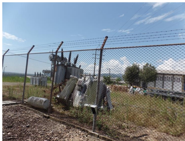
IMAGEN 12. ESPACIO DE UNA POSIBLE AMPLIACIÓN. ACTUALMENTE ES USADO COMO ZONA DE APILAJE Y BODEGA
