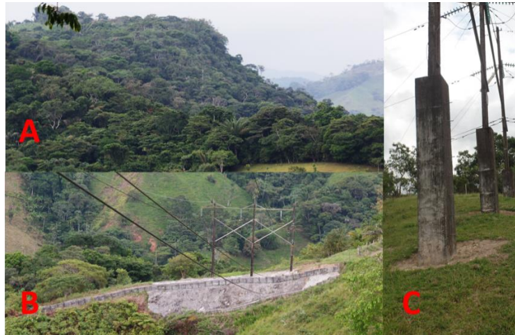
IMAGEN 11. A) GEOFORMA DE CUESTA CON LA LADERA DE CONTRAPENDIENTE A LA DERECHA Y LA ESTRUCTURAL A LA IZQUIERDA DE BAJO GRADO. B) ESTRUCTURAS DE CONTENCIÓN DE TIERRAS POR REMOCIÓN EN MASA EN BASES DE TORRES. C). EROSIÓN EN BASES DE TORRES POR LA FALTA DE COBERTURA
