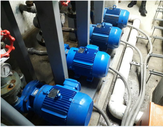
Figura 8. Sistema de bombeo de agua
