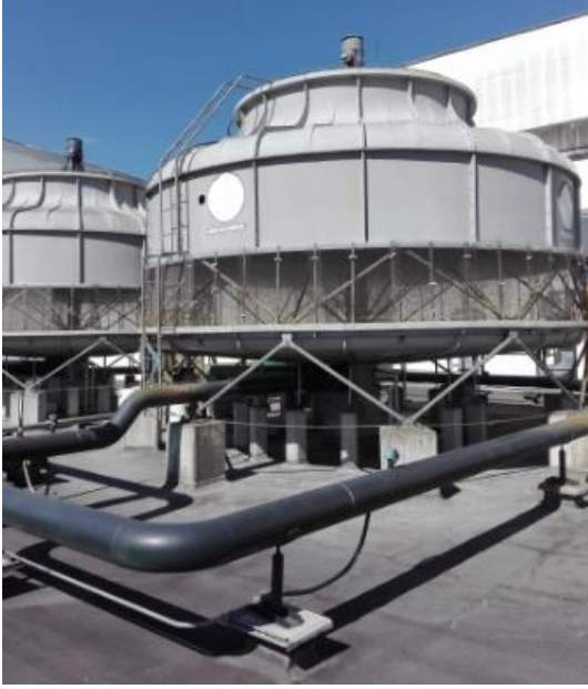
Figura 7. Sistema de aire acondicionado
