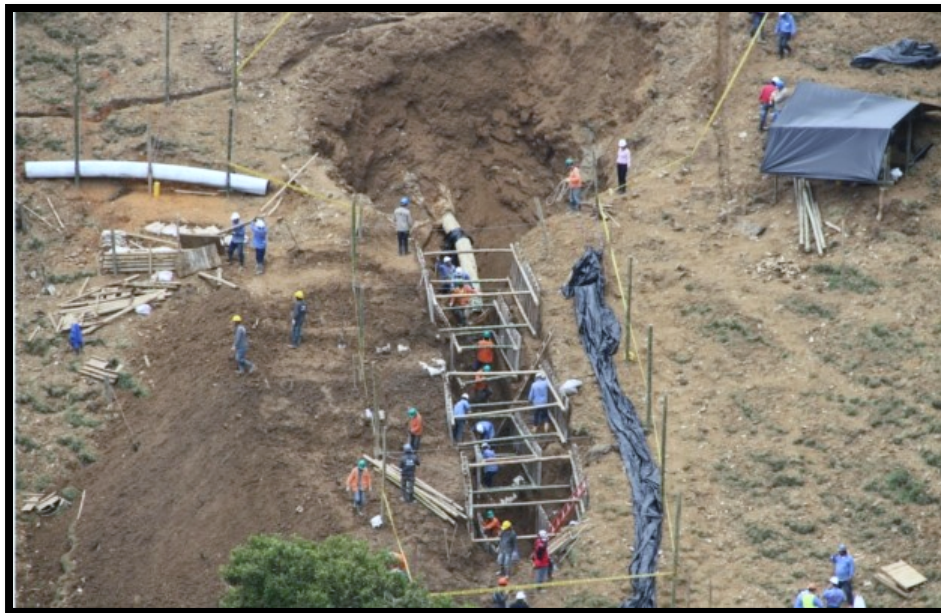
Figura 9. Inestabilidad del terreno ocurrida en noviembre 18 del 2011 deja a 492 usuarios del eje cafetero y del valle sin gas natural. (Tomado de la página de la PATRIA).
