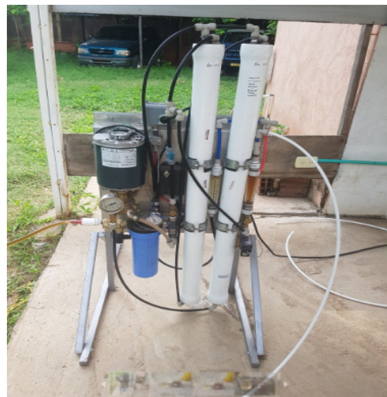
Figura 22: Planta de Osmosis Inversa. Fuente Propia, 2019
