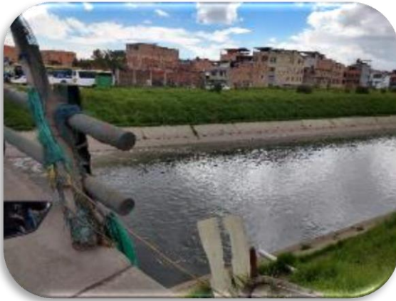
Imagen 15. Vertimientos en el tramo IV. Fuente: Autora, (2018)
