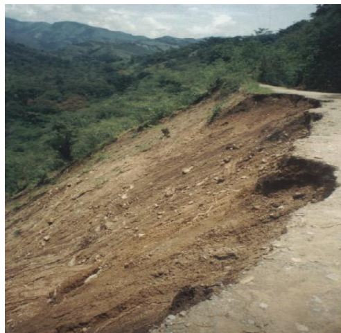
Figura 16. Foto: movimiento en masa que afecto la vía que de Rioblanco conduce a la vereda de bocas.
