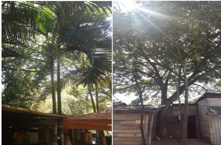
Figura 18. Viviendas establecidas en medio de árboles generando riesgo a los árboles y a la infraestructura
