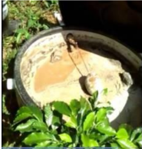
Figura43. Recámara dosificadora colmatada.
