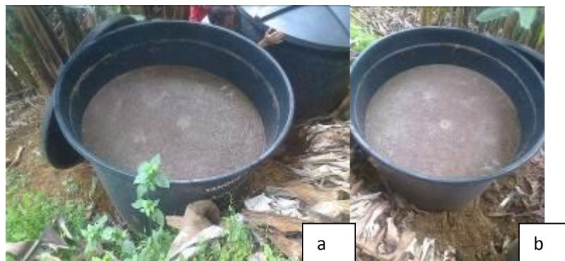
Figura 56. Niveles de los dos Reactores hidrolíticos de flujo ascendente
