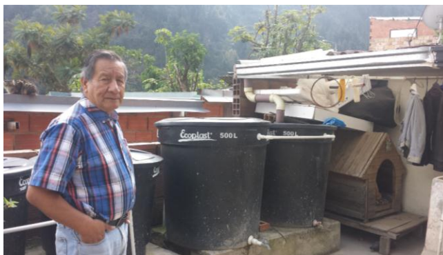
Figura 1. Tanques de Almacenamiento de agua lluvia. Experiencia del Señor Diogenes Chaves Benavides, Barrio La Gran Colombia. San Cristobal – Bogotá.
