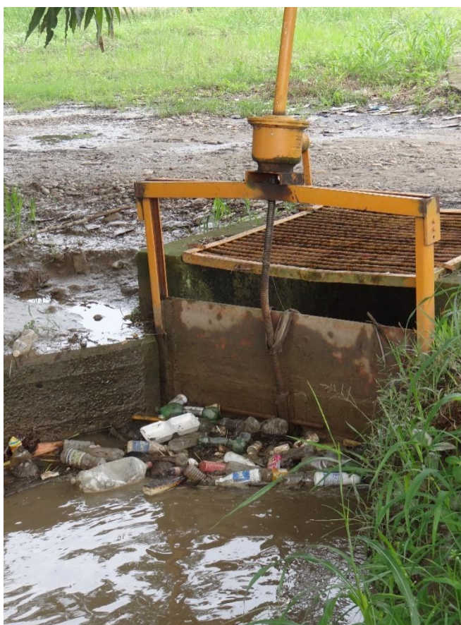
Figura 9. Los envases obstaculizan el normal funcionamiento de las válvulas de control de flujo del agua en los canales.
