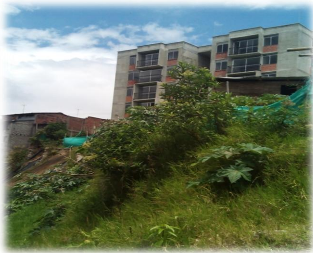
Esta imagen corresponde a la construcción de las torres de las unidades de ejecución 1, 2 y 3
