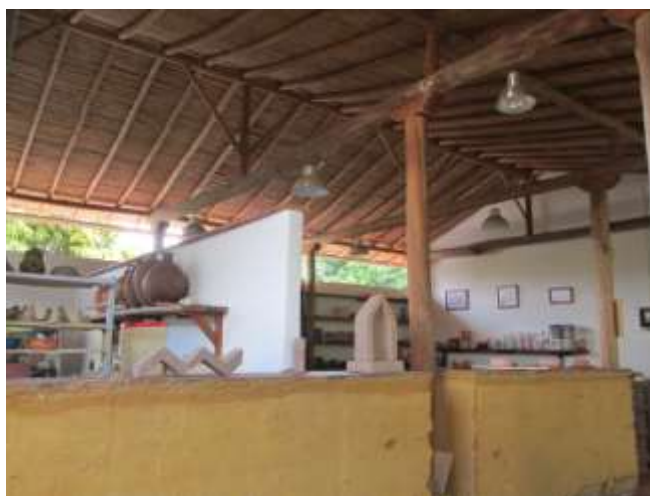
Fotografía 5-7: Cubierta de barro y entramado de madera, Escuela de Artes y Oficio - Barichara
