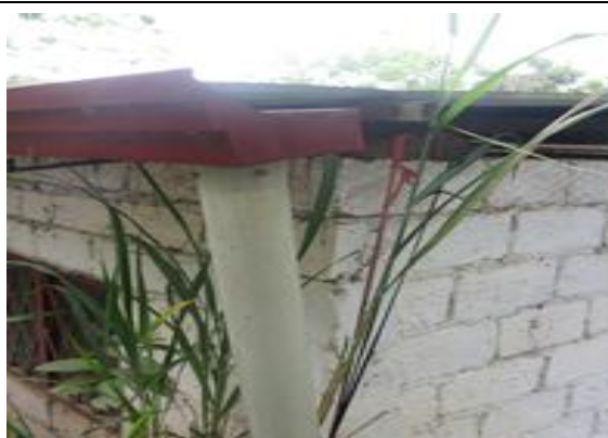
Imagen 10: Canal y tubería para la conducción del agua captada en galpón.
