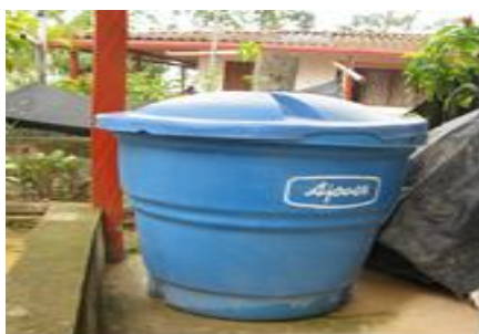
Imagen 14: Tanque con capacidad de 200 litros.
