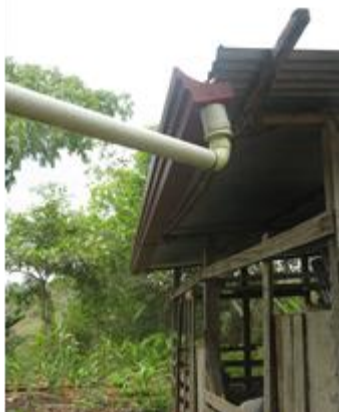
Imagen 8: Canal y tubería para la conducción del agua captada en el aprisco.
