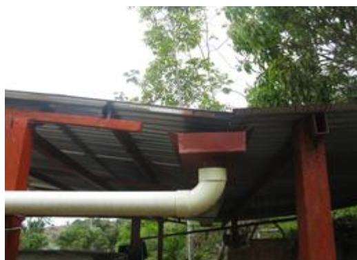
Imagen 11: Canal y tubería para la conducción del agua captada en el garaje.
