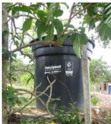
Imagen 16: Tanque con capacidad de 2.000 litros.
