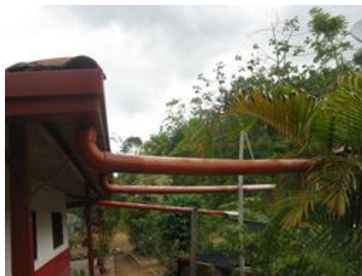
Imagen 9: Canal y tubería para la conducción del agua captada en la casa de cuatro aguas.
