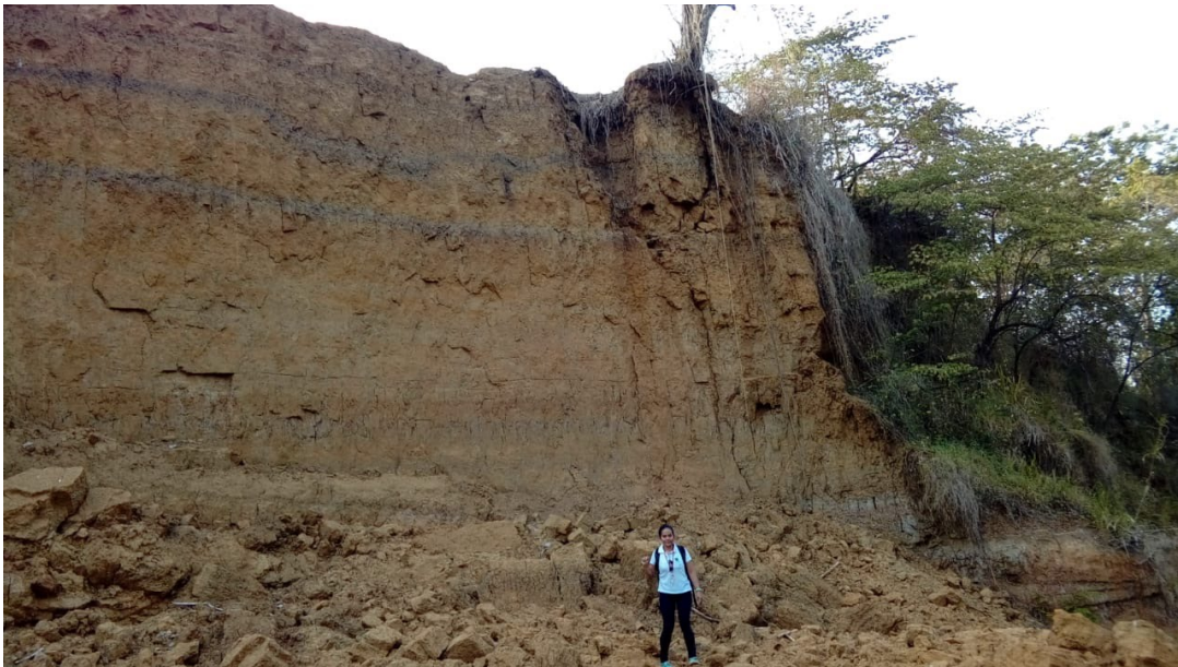
Ilustración Anexo 2: Desplome del talud observado el 27 de marzo 2018
