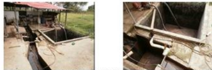
Imagen 7 y 8: Panorámica de caja y tanque estercolero donde son llevadas las aguas residuales.
