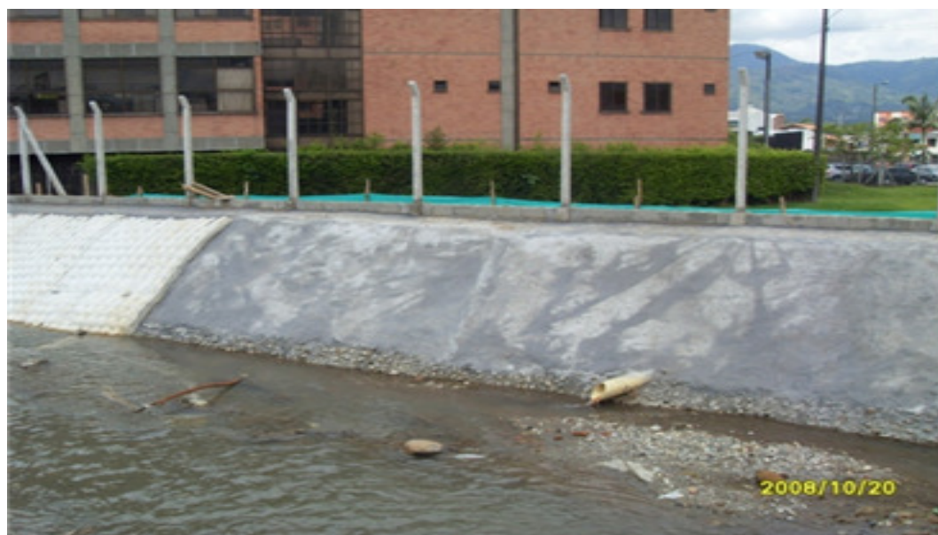
Gráfico 37. Ex filtración de aguas residuales por taludes
