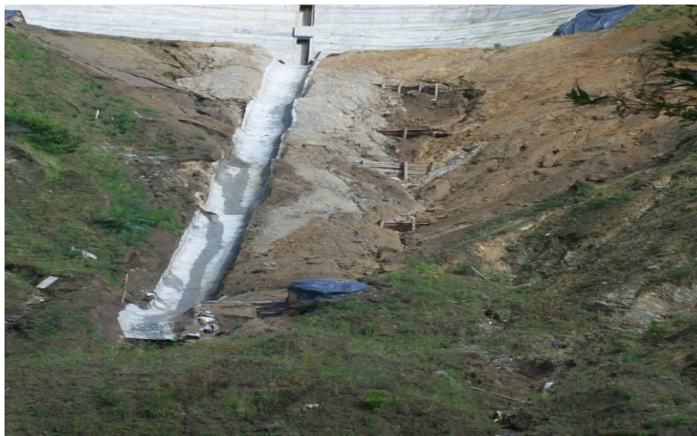
FIGURA 54. OBRA DE CANALIZACIÓN INADECUADA EN LA BASE DE LA PLAQUETA, CERRO DE ORO
