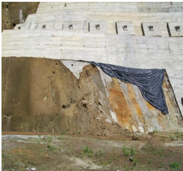
FIGURA 64. OBRAS INCONCLUSAS SECTOR CERRO DE ORO, BASE DE CONSTRUCCION PLAQUETAS DE CONCRETO.
