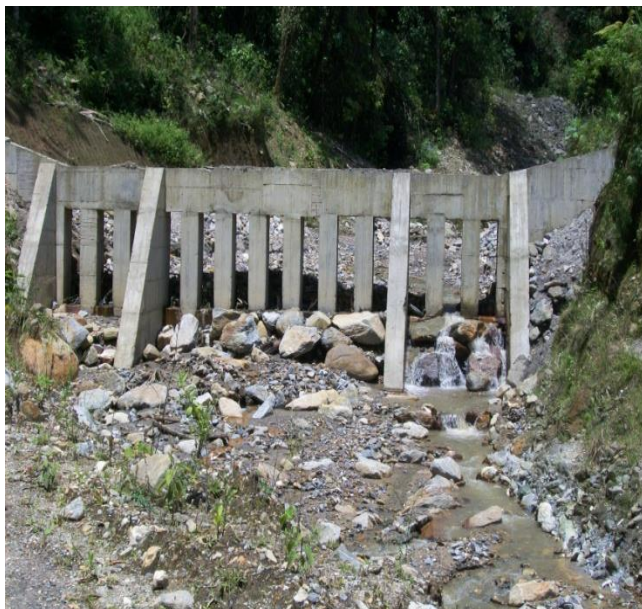
FIGURA 72. DIQUE SOBRE EL LECHO DE LA MICRO CUENCA INSUFICIENTE PARA DISIPAR UNA AVENIDA – SECTOR BAJO ANTES DE EXPOFERIAS.
