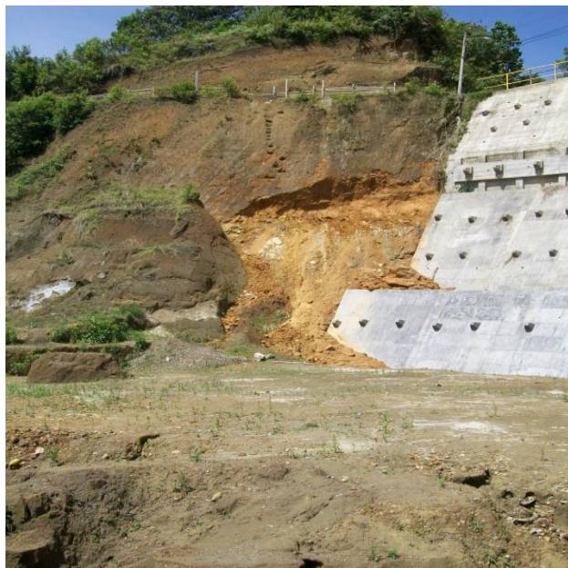
FIGURA 68. OBRAS, SECTOR CURVA DEL MICO, PROCESO ACTIVO AFECTANDO OBRA, TRINCHOS PROTEGIENDO DESAGUES MAL CONSTRUIDOS.
