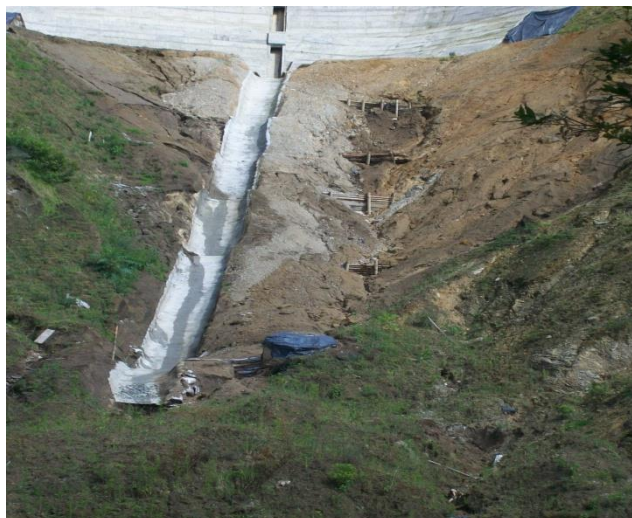
FIGURA 71. PROCESOS EROSIVOS ACTIVOS LECHO DE LA MICRO CUENCA Y OBRAS EN MAL ESTADO- SECTOR CERRO DE ORO
