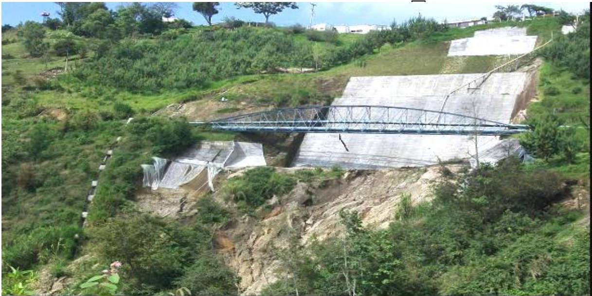
FIGURA 42. DESLIZAMIENTO EN LA PATA DE LA ESTRUCTURA DE LA PANTALLA DE CONCRETO, DESESTABILIZANDO LA MISMA.
