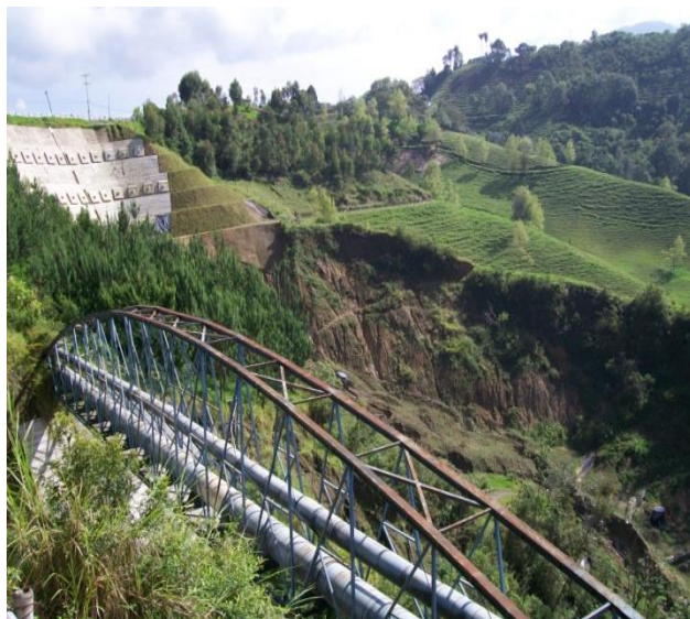
FIGURA 69. PROCESOS EROSIVOS ACTIVOS AFECTANDO OBRAS Y LADERA, CERRO DE ORO.
