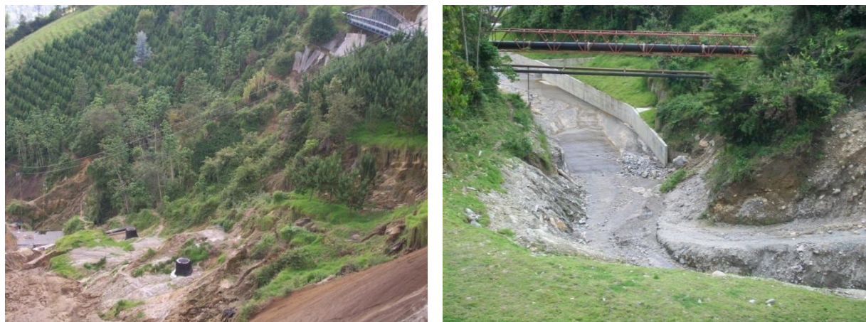
FIGURA 80. OBRAS INCONCLUSAS EN LA MICRO CUENCA SECTORES CERRO DE ORO Y
