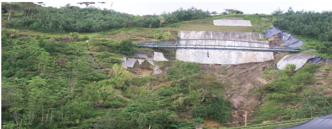
FIGURA 77. PROCESO DEGRADATIVO AFECTADO LA PATA DE LAS PLAQUETAS DE CONCRETO DEL SECTOR CERRO DE ORO.
