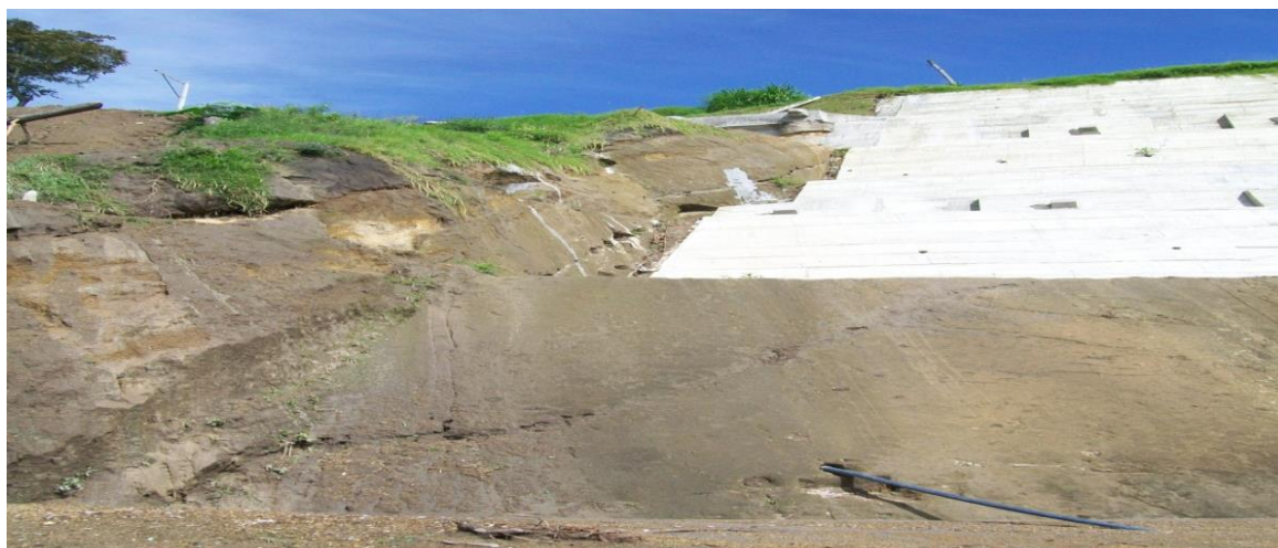
FIGURA 59. CANALIZACIÓN INADECUADA EN LA OBRAS DE CONCRETO EN EL CERRO DE ORO
