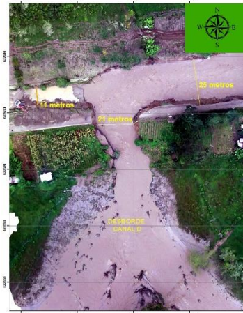
Fotografía 2. Ortofoto tomada con dron para medir dimensiones de zona afectada por erosión y ruptura del Canal D, día lunes 19 de Julio 2021.
