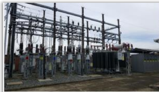
Figura 5 Subestación de Distribución CHEC
