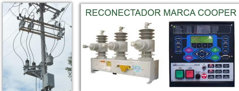
Figura 6 Reconector Red Distribución 13.2 kV CHEC
