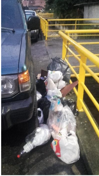
Residuos sobre alcantarilla
