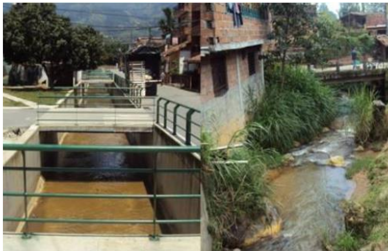
Figura 5 Punto crítico de desbordamiento, por parte de los caños que ingresan al casco urbano del municipio de sabaneta. Tomado de Área Metropolitana del Valle de Aburrá. (2011). Fortalecimiento de los comités ambientales barriales y veredales CUIDÁ, para la construcción de un sistema de alerta temprana en el Valle de Aburrá. Plan local de emergencias CUIDÁ Calle Larga - Municipio de Sabaneta. Medellín: Área Metropolitana del Valle de Aburrá.
