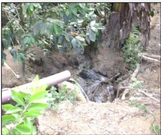
Figura 30. Aguas residuales. Fuente Autor
