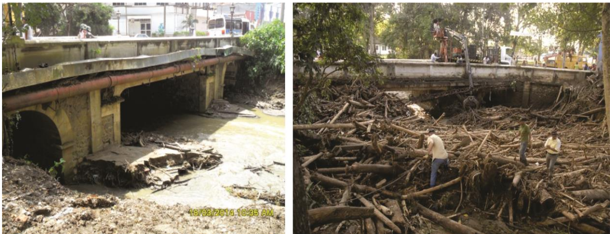
Imagen No. 3- Inundación Barrio Bolívar - diciembre 2013.
