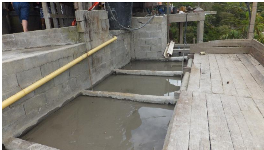
Imagen 3. Lagunas de tratamiento de lodos
