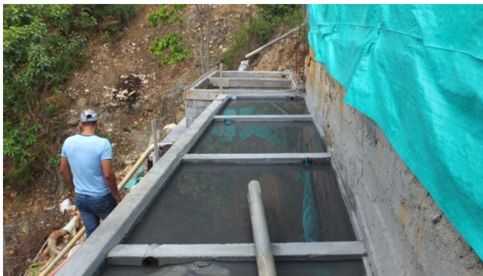
Imagen 7. Tanques de sedimentación
