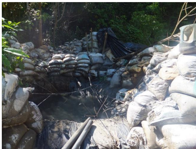
Imagen 14. Almacenamiento de lodos Corregimiento Llanos de Uruarco
