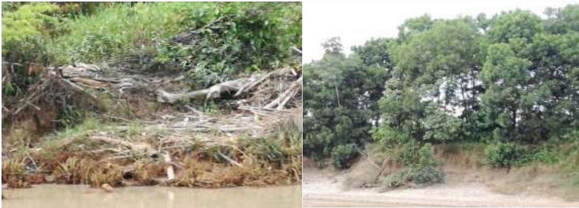
Figura 10. Caída de Taludes por erosión de la ronda del Rio Quito Fuente: Propia
