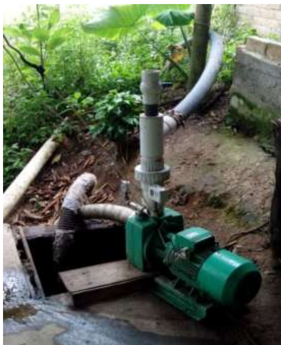
Imagen No 7 Motobomba para la extracción de lixiviados
