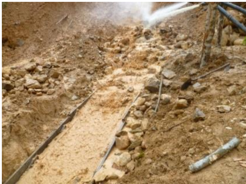
Figura 3-31. Explotación de minerales con golpe al talud
