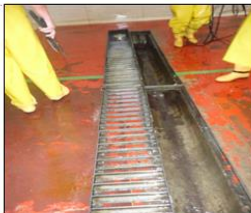
Figura 1-11. Rejilla interna de retención de sólidos en el Frigorífico Jongovito
