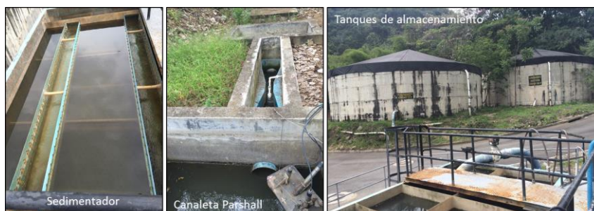
Figura 1-5. Sedimentador, canaleta Parshall y tanques de almacenamiento de las Plantas de Tratamiento de Agua Potable del Frigorífico Vijagual
