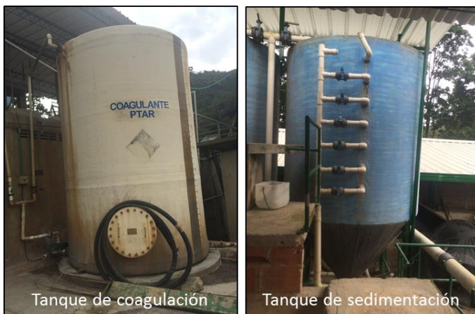
Figura 1-7. Tanque de coagulación y de sedimentación de la Planta de Tratamiento de Agua Residual del Frigorífico Vijagual
