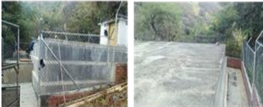
Imagen 7 Tanque de Almacenamiento
