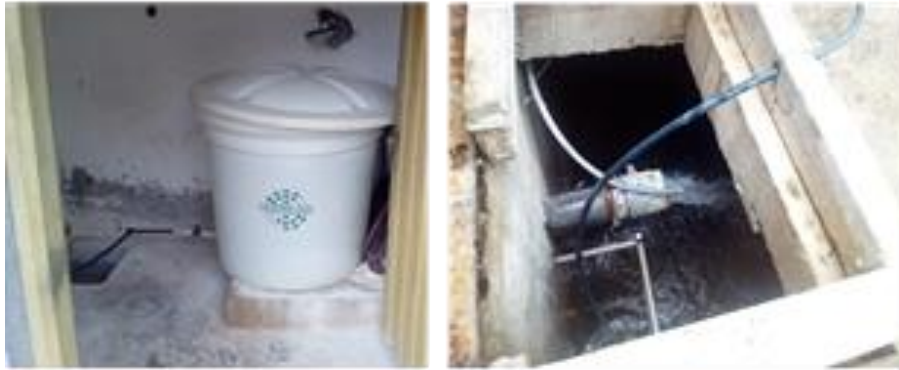
Imagen 9. Tanque de dosificación Cloro y Punto de aplicación
