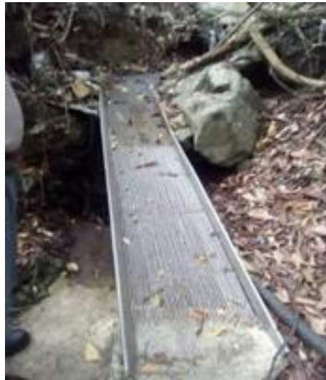
Imagen 2. Rejilla de captación Inicial, destruida por avalancha
