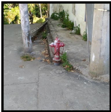
Figura 18. Hidrante y válvula auxiliar de hidrante.
