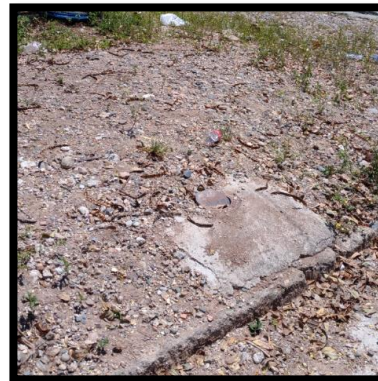
Figura 17. Válvula de corte de la red de distribución.
