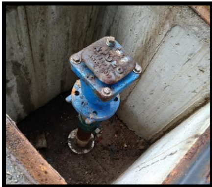
Figura 16. Válvula de ventosa de la red de distribución.
