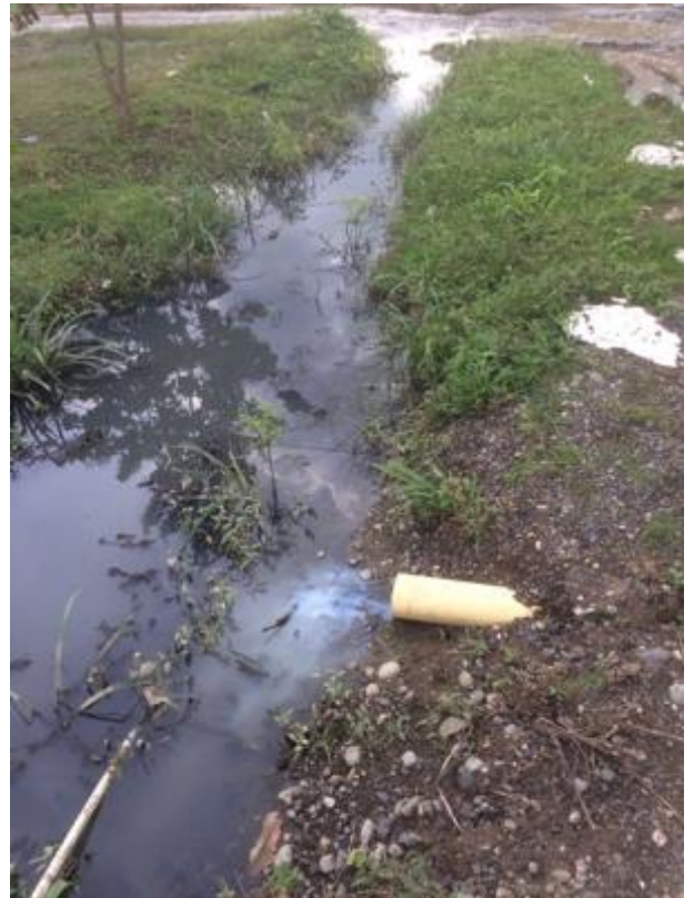
Ilustración 15. Sistema de alcantarillado en El Porvenir
