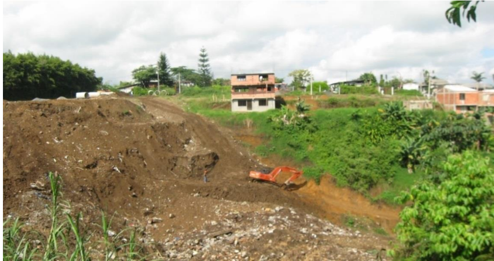
Ilustración 11 – Fotografía Escombrera Guadalcanal
