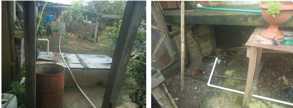
Manguera de conducción de agua a las viviendas
