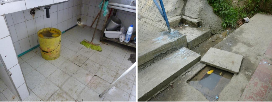
Imagen 9. Inadecuada disposición de las aguas residuales provenientes de la cocina. Fuente: Claudia Neusa (2015).
