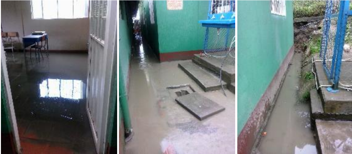
Imagen 7. Fotos de la inundación del colegio San Lorenzo debido al taponamiento de zanjas y canales. Fuente: Claudia Neusa (2015).
