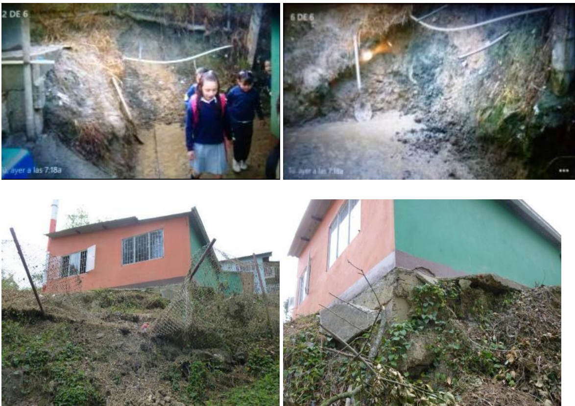
Imagen 8. Diferentes locaciones de la institución que han presentado inestabilidad del terreno debido a infiltraciones de agua. Fuente: arriba Jaime Cotrino (2015), abajo Claudia Neusa (2015).
