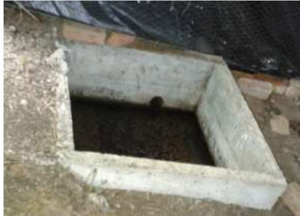
Figura 17. Caja de salida construida en ladrillo, repellada y esmaltada.
