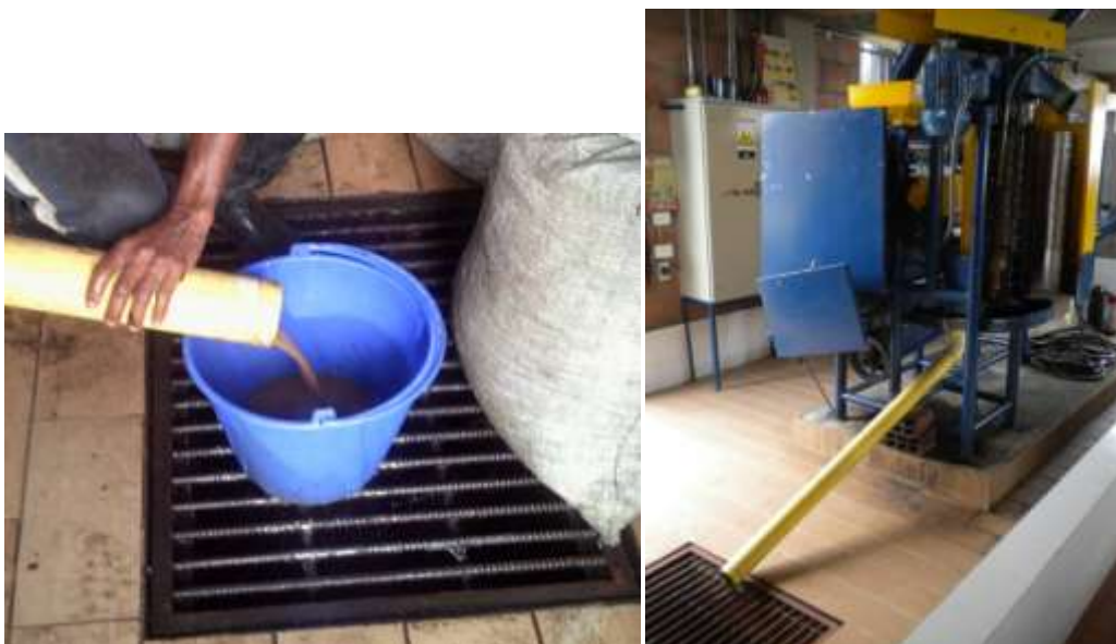
Figura 19. Tubo que dirige la mezcla agua-mucílago al tratamiento.
