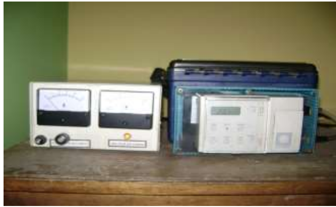
Figura 5. Bomba de succión y cargador de batería.
