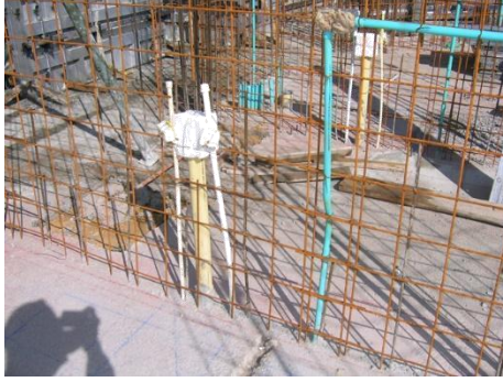
Figura 5. Colocación de acero de refuerzo e instalaciones domiciliarias en sistemas industrializados de construcción.
