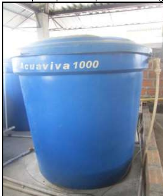
Figura 11. Tanque de polietileno para almacenar agua lluvia
