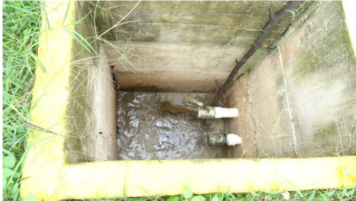
Figura 4-9: Válvulas de purga de desarenadores
