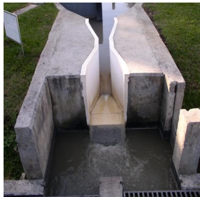
Figura 4-12: Sistema de aforo: Canaleta Parshall
