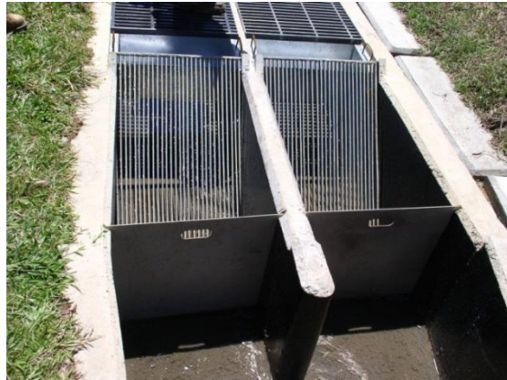
Figura 4-5: Rejas de cribado y compuertas para sacarlas de servicio
