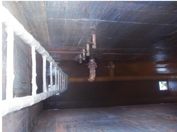
Figura 4-14: Valvulas de muestreo de lodos
