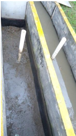
Figura 4-10: Escurrimiento de lodos en desarenadores
