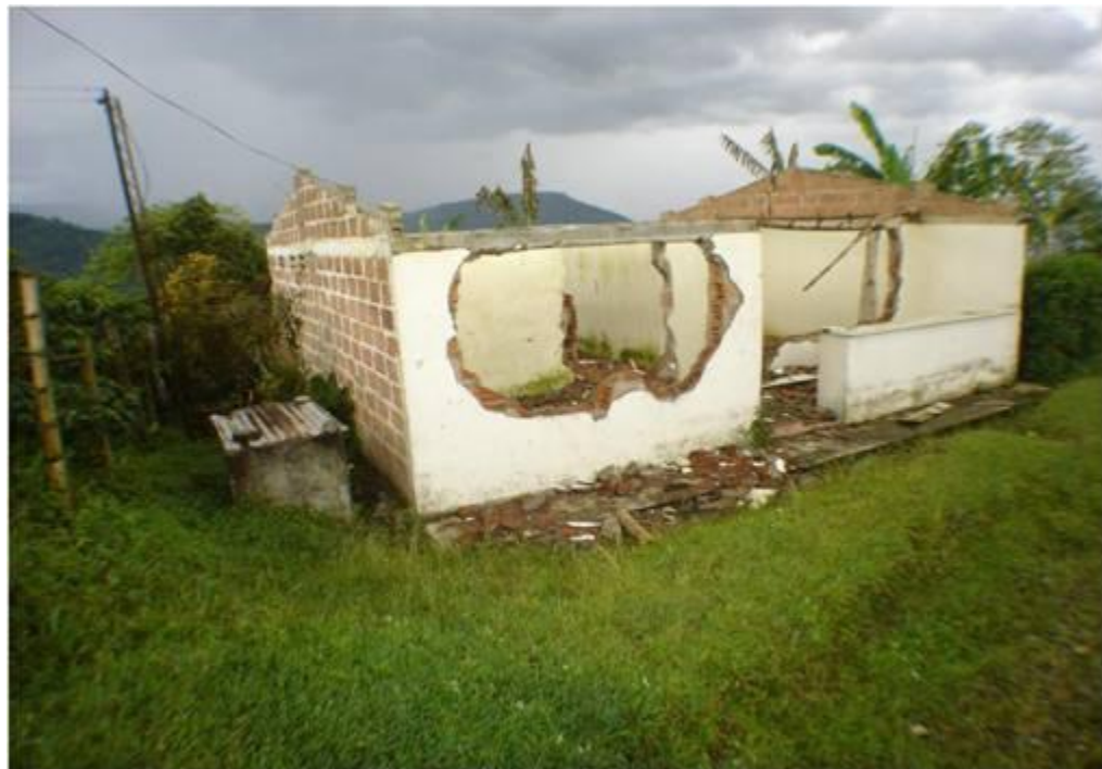
Figura 95. Vivienda evacuada y demolida innecesariamente por la creencia de la presencia de una falla geológica ser la causante de los movimientos en masa de la región. Septiembre de 2008. Vivienda sobre vía carreteable que conduce de Pácora a San Bartolomé. Municipio de Pácora Vereda San Bartolomé, sector El Escobal.
