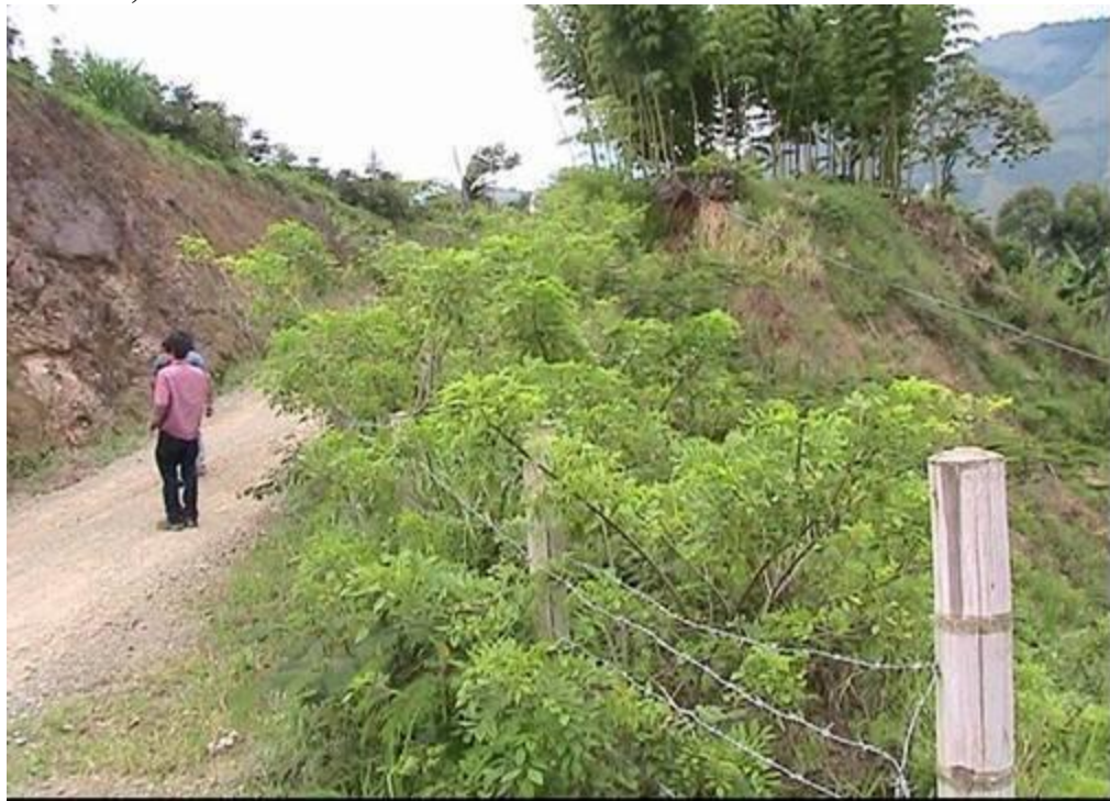
Figura 126. Se lograron las metas, lo que se demuestra en un año y once meses de haberse construido las obras agosto de 2010. Vía carreteable que conduce de Pácora a San Bartolomé. Municipio de Pácora Vereda San Bartolomé, sector el Escobal.
