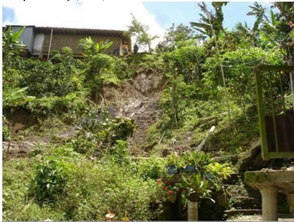
Figura 46. Lote con problemas de soliflujión, afectando en la parte alta y baja de la ladera dos viviendas, las cuales eran objeto de desalojo por parte del municipio de Filadelfia y CORPOCALDAS. Vereda Balmoral municipio de Filadelfia, Caldas, Colombia.
