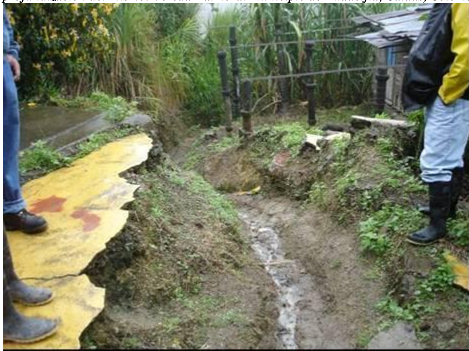
Figura 37. Encauzamiento de aguas de escorrentía camino abajo hasta encontrar la vía principal. Se observa la profundización del mismo. Vereda Balmoral municipio de Filadelfia, Caldas, Colombia.
