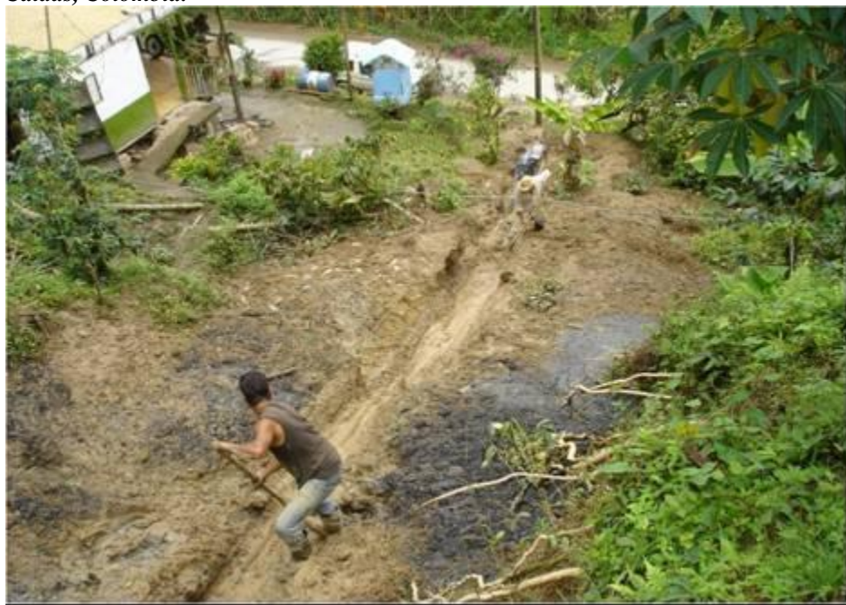
Figura 59 Julio 8 de 2008. Construcción de zanjas profundas y colocación de filtros temporales en guadua, para evitar inicialmente que la zanja se cierre nuevamente como consecuencia de la saturación alta del terreno, y así mismo, inducir al terreno a drenarse para continuar con las obras. Vereda Balmoral municipio de Filadelfia, Caldas, Colombia.
