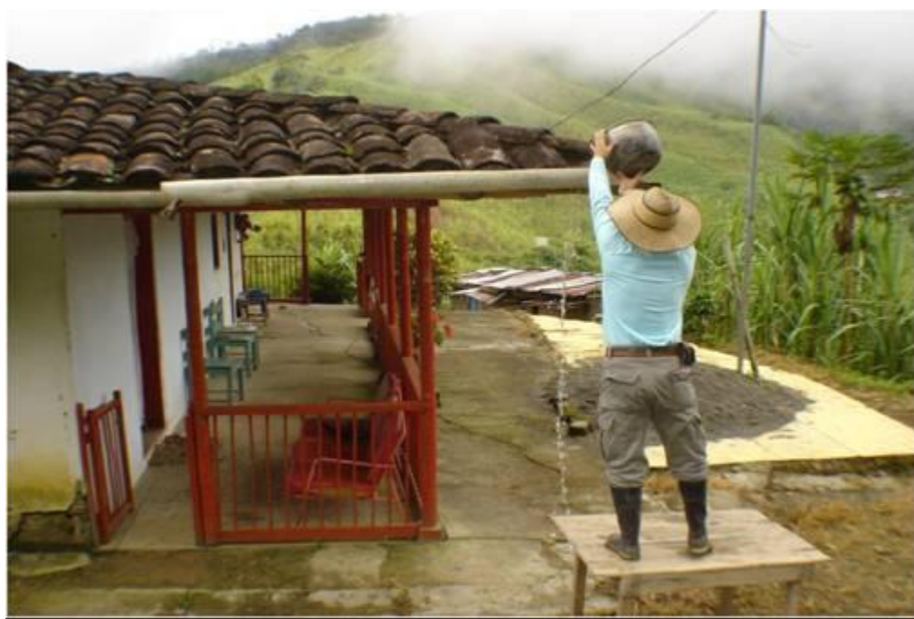
Figura 31. Mal funcionamiento de las canaletas para evacuar aguas lluvias, las cuales van directamente al terreno casando erosión y saturación del mismo. Julio de 2008. Vereda Balmoral municipio de Filadelfia, Caldas, Colombia.
