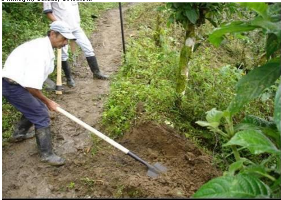
Figura 52 Abertura de ventanas, para la evacuación de aguas de escorrentía provenientes de la carretera. Las ventanas se realizaron desde la parte alta del camino de herradura hasta la carretera principal. Las ventanas se realizaron cada 5 m de distancia una de otra, para manejar caudales pequeños. Vereda Balmoral municipio de Filadelfia, Caldas, Colombia
