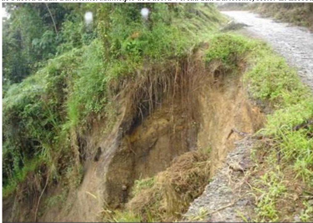
Figura 93. Sitio por donde se concentran las aguas de escorrentía provenientes de la cuneta de la carretera aguas arriba. Se observa el socavamiento de la banca de la carretera. Septiembre de 2008. Vía carreteable que conduce de Pácora a San Bartolomé. Municipio de Pácora Vereda San Bartolomé, sector El Escobal.
