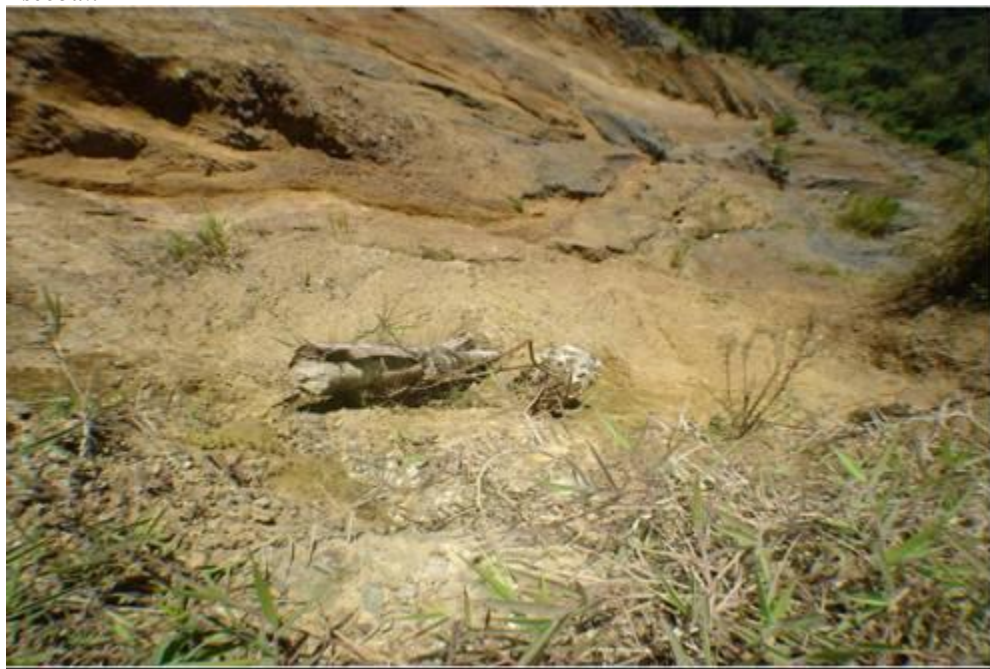
Figura 90. Obras construidas con guadua hueca por dentro y rellena de hierro y concreto, como una falsa bioingeniería. Vía San Bartolomé, sector El Escobal, municipio de Pácora, Caldas. Septiembre de 2008. Vía carretable que conduce de Pácora a San Bartolomé. Municipio de Pácora Vereda San Bartolomé, sector El Escobal.
