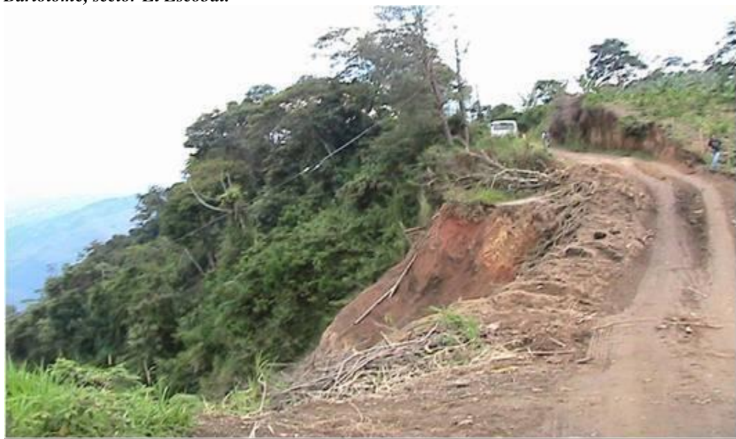
Figura 111. Destrucción de parte de la obra de bioingeniería entre los sectores 1 y 2 para ser reemplazada por un muro de concreto. Esto demuestra la fortaleza que brinda las obras de bioingeniería en la estabilización de las laderas. Abril de 2011. Vía carreteable que conduce de Pácora San Bartolomé. Municipio de Pácora Vereda San Bartolomé, sector El Escobal.
