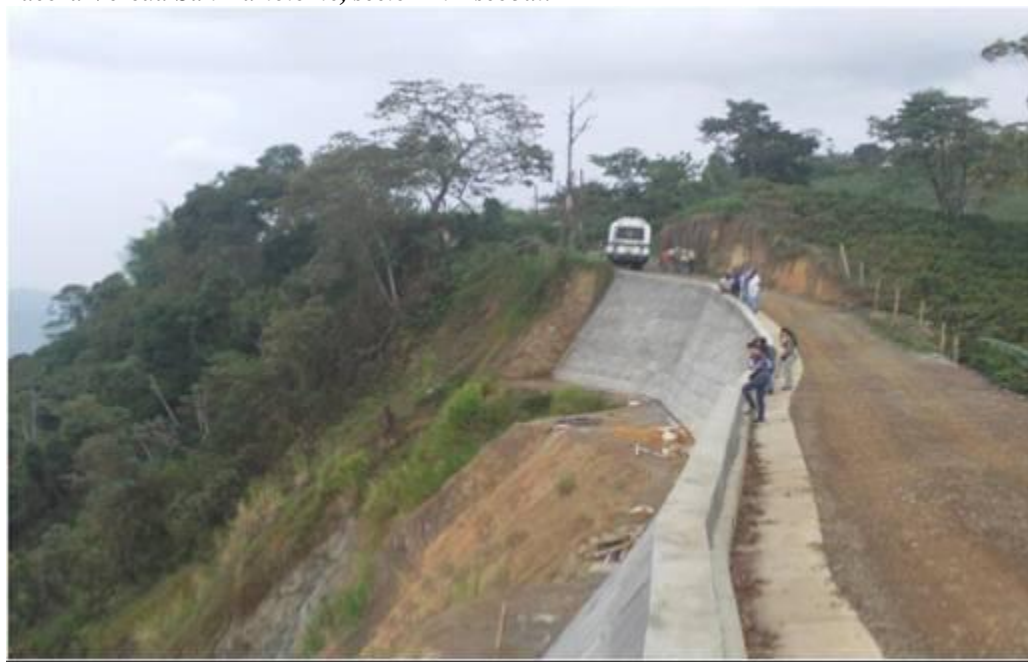
Figura 112. Se observa entre los sectores 1 y 2, luego de estabilizado los taludes con obras de bioingeniería, parte de ellos, especialmente la zona alta del talud, fue reemplazada por un muro de concreto por valor de 100 millones de pesos aproximadamente. Valor similar al presupuesto de todo el proyecto de bioingeniería para la zona. Imagen tomada en agosto de 2012. Vía carretable que conduce de Pácora a San Bartolomé. Municipio de Pácora Vereda San Bartolomé, sector El Escobal.
