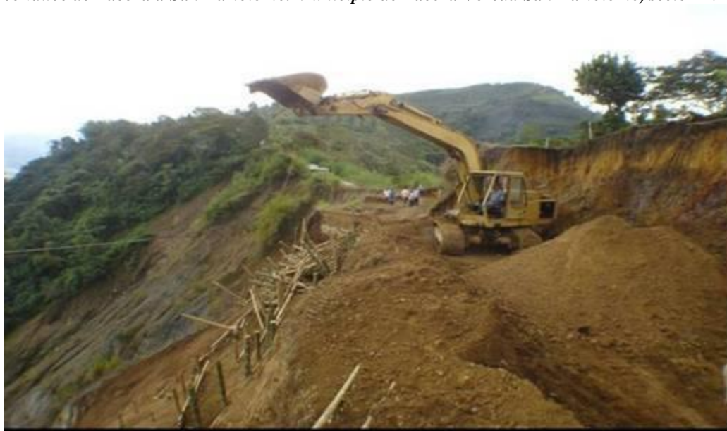
Figura 115. Sector 3. Daños ocasionados a las obras de bioingeniería con el uso indebido de la maquinaria de la secretaría de obras de empresas públicas del departamento de caldas. Noviembre de 2008. Vía carreteable que conduce de Pácora a San Bartolomé. Municipio de Pácora Vereda San Bartolomé, sector El Escobal.
