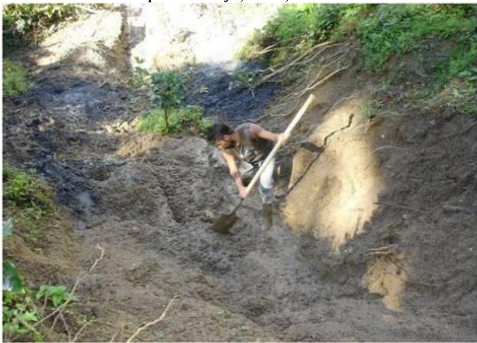
Figura 58. Área mal drenada y totalmente sobresaturada en la parte alta del talud y que tiene en riesgo alto a dos viviendas. Vereda Balmoral municipio de Filadelfia, Caldas, Colombia.
