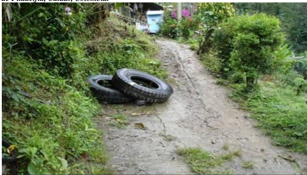
Figura 50. Vía de entrada a la finca, parcialmente obstruida reptación del terreno. Vereda Balmoral municipio de Filadelfia, Caldas, Colombia.
