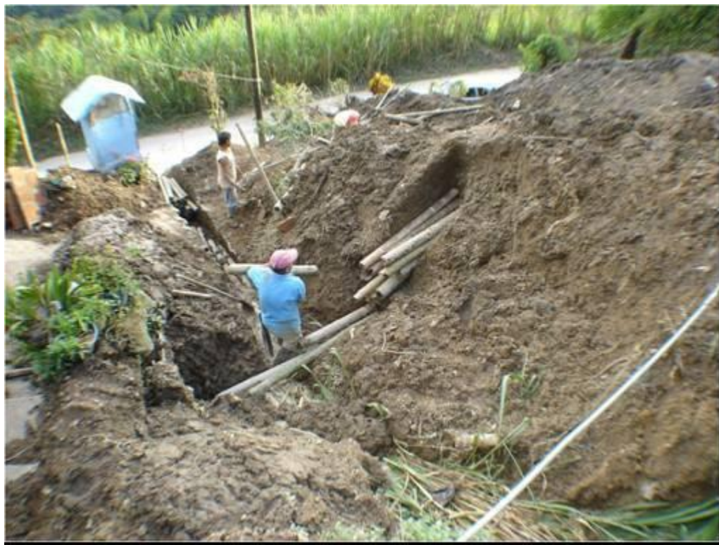
Figura 72. Construcción de nueva sección de filtro vivo. Se observa un tramo de filtro cubierto de pasto, para posteriormente ser cubierto con tierra (agosto de 2008). Vereda Balmoral municipio de Filadelfia, Caldas, Colombia.
