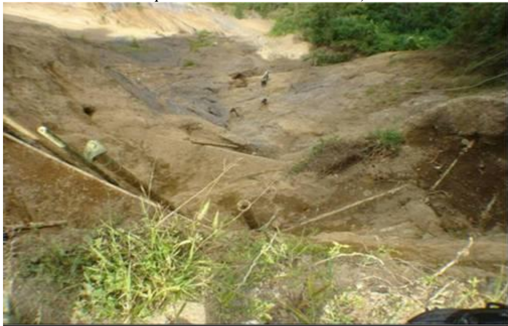
Figura 106. Sector 2. Se aprecia la construcción de trinchos vivos escalonados desde arriba hacia abajo, como disipadores de energía de aguas de escorrentía en el segundo sector crítico del área afectada. El 1% del área presentaba cobertura vegetal. Corregimiento San Bartolomé sector El Escobal municipio de Pácora, Caldas. Noviembre de 2008. Municipio de Pácora Vereda San Bartolomé, sector El Escobal.
