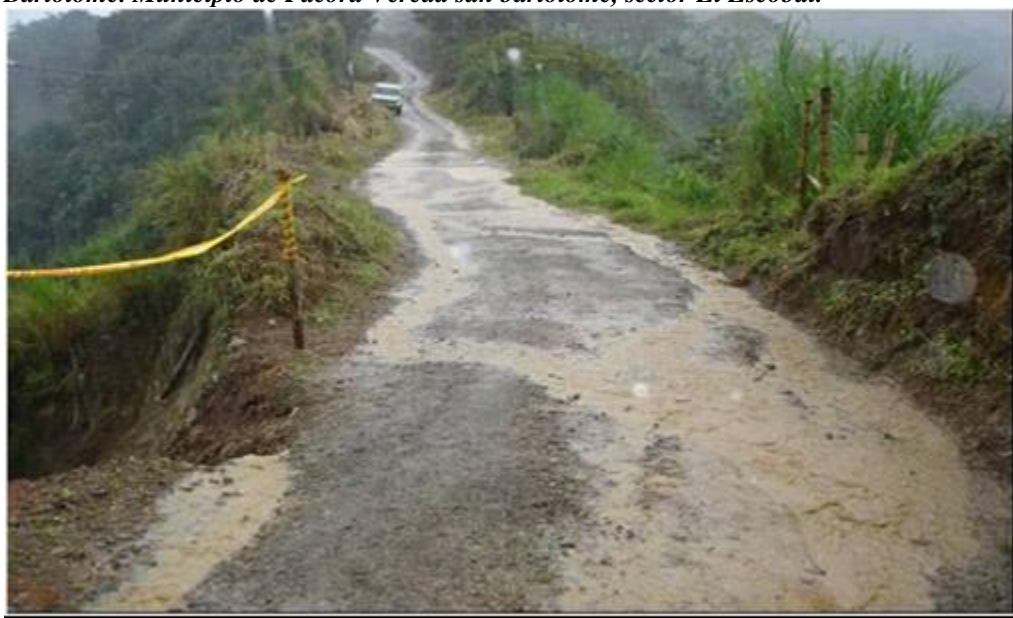
Figura 82. Vereda El Escobal municipio de Pácora. Avance de las aguas lluvias sobre la banca de carretera. Se observa que por donde se concentran las aguas de escorrentía, inmediatamente se forma una cárcava que da origen a la pérdida de la banca de la carretera. Julio de 2008. Vía carreteable que conduce de Pácora a San Bartolomé. Municipio de Pácora Vereda san bartolomé, sector El Escobal.
