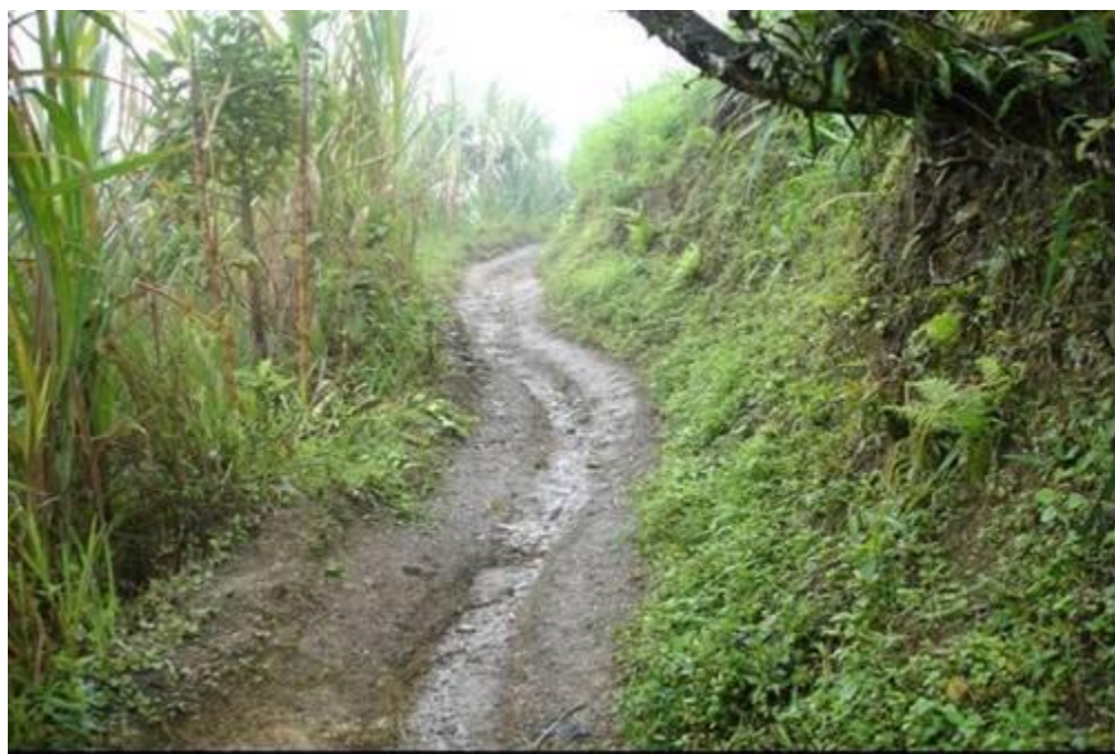
Figura 41. Tramo de la carretera que conduce a la Vereda Balmoral. Se observa el encauzamiento de las aguas de escorrentía, que causan problemas aguas abajo por la concentración de las mismas en invierno. Vereda Balmoral municipio de Filadelfia, Caldas, Colombia.
