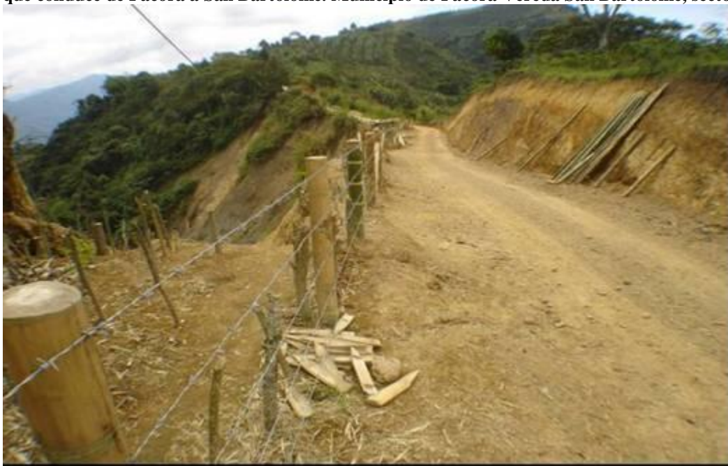
Figura 123. Aislamiento con cerco de alambre de púas del área afectada. Febrero de 2009. Vía carretable que conduce de Pácora a San Bartolomé. Municipio de Pácora Vereda San Bartolomé, sector El Escobal.
