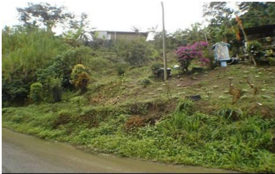
Figura 49. Talud con problemas de reptación. Vereda Balmoral municipio de Filadelfia, Caldas, Colombia.
