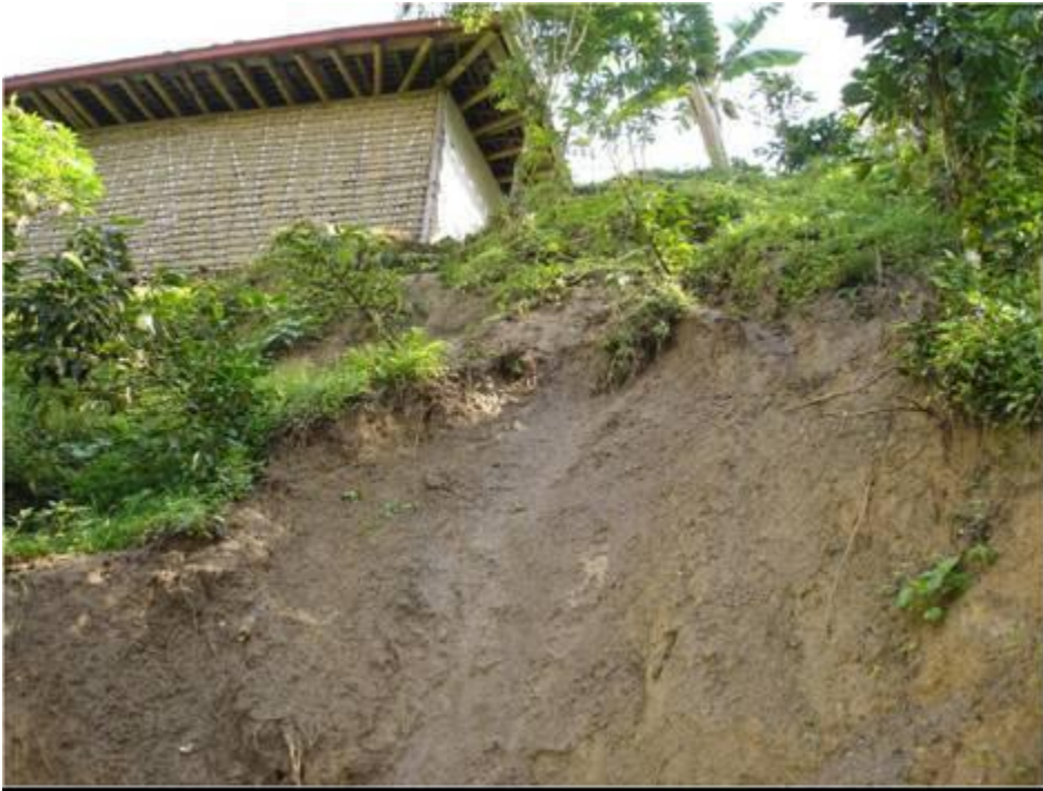
Figura 39. Terreno saturado, con procesos de movimiento en masa, poniendo en riesgo la vivienda. Se observa como las aguas de la canaleta del techo, llegan directamente al sitio problema. Vereda Balmoral municipio de Filadelfia, Caldas, Colombia.
