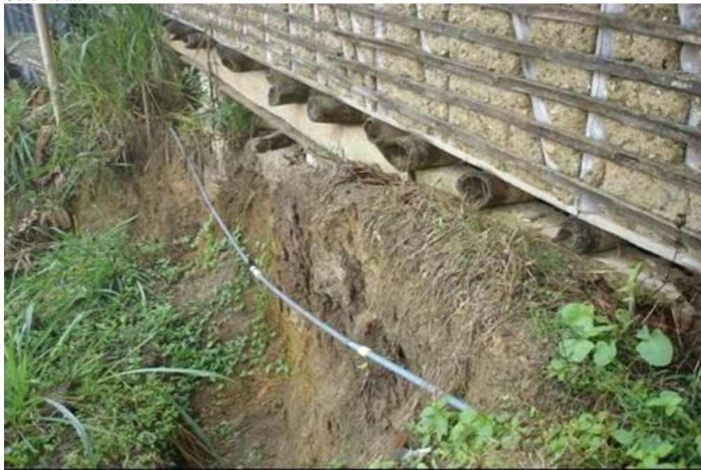
Figura 47 Talud con procesos de movimiento en masa, desestabilizando el cimiento de la vivienda. Se observa la presencia de una manguera de acueducto con varios empates, lo que indica que pudo haber influido en parte al desconectarse en la erosión y deslizamiento del talud. Vereda Balmoral municipio de Filadelfia, Caldas, Colombia.
