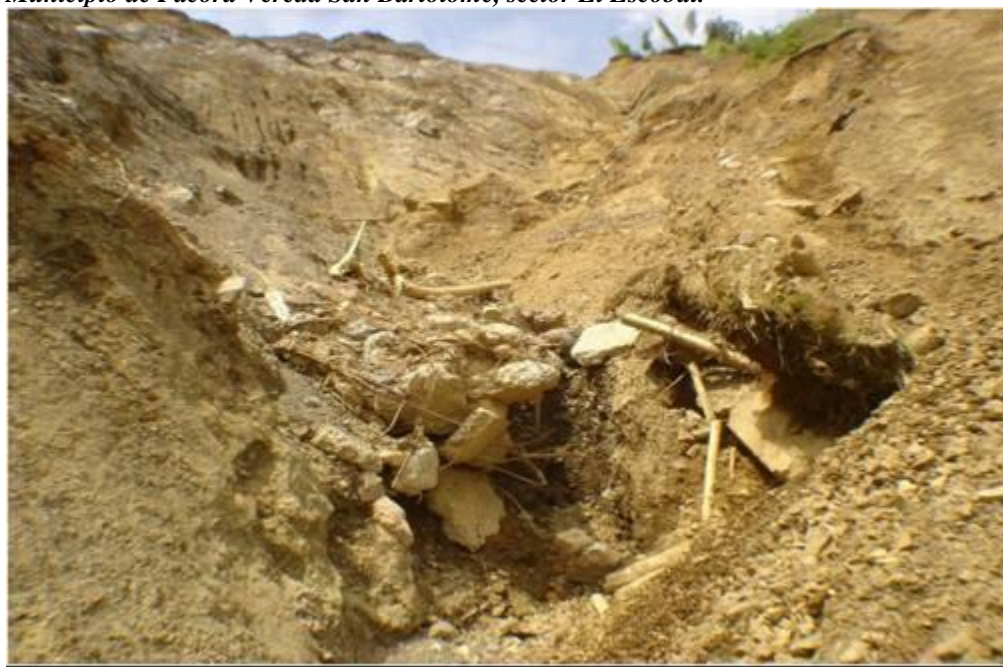
Figura 92. Obras de concreto de ingeniería convencional, colapsadas y transportadas desde la banca de la carretera hasta la parte baja por efecto de la fuerza de gravedad y las lluvias. San Bartolomé, sector El Escobal municipio de Pácora, Caldas. Enero de 2009. Vía carreteable que conduce de Pácora a San Bartolomé. Municipio de Pácora Vereda San Bartolomé, sector El Escobal.
