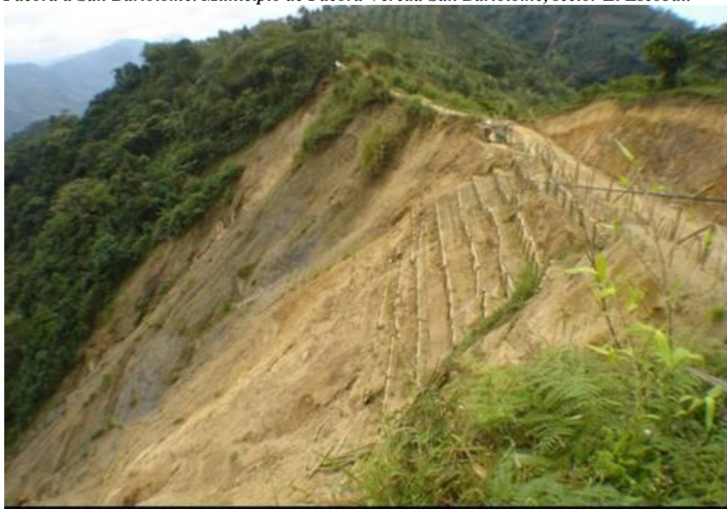
Figura 120. Aislamiento con alambre de púas del talud bajo de la vía que conduce del corregimiento San Bartolomé sector El Escobal al municipio de Pácora, Caldas. Febrero de 2009. Vía carreteable que conduce de Pácora a San Bartolomé. Municipio de Pácora Vereda San Bartolomé, sector El Escobal.
