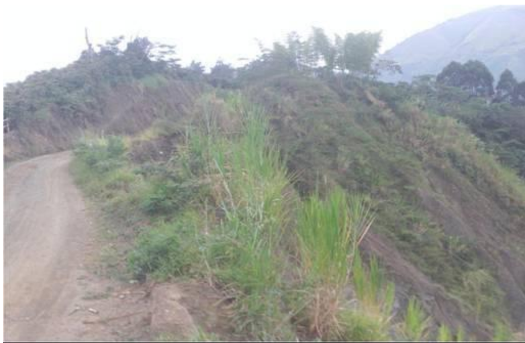
Figura 128. Efectividad de las obras de bioingeniería, desde septiembre de 2008 hasta agosto de 2012. Vía carreteable que conduce de Pácora a San Bartolomé. Municipio de Pácora Vereda San Bartolomé, sector el Escobal.
