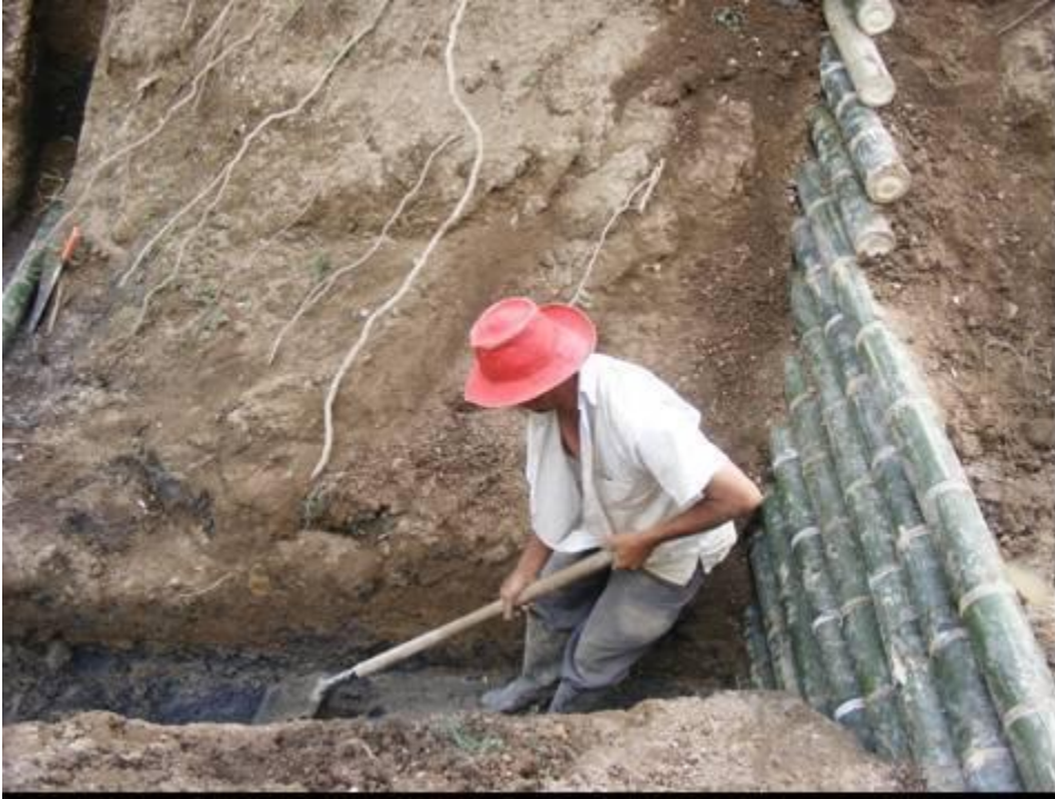
Figura 67. Construcción de cama para acomodar un tramo de filtro vivo en guadua. Vereda Balmoral municipio de Filadelfia, Caldas, Colombia.
