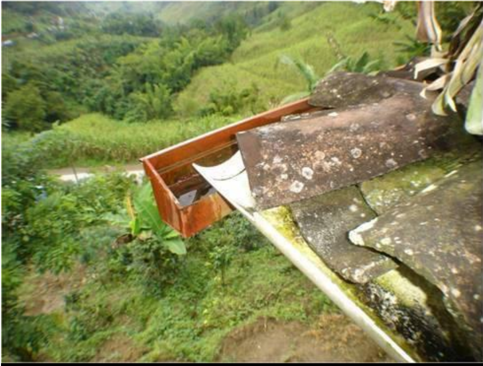
Figura 32. Se observa la canal con pendiente contraria al avance del flujo de agua, desbordándose y yendo directamente al terreno. Vereda Balmoral municipio de Filadelfia, Caldas, Colombia.
