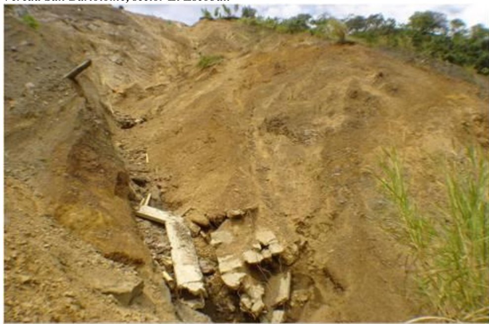
Figura 91. Obras de concreto de ingeniería convencional, colapsadas y transportadas desde la banca de la carretera por efecto de la fuerza de gravedad y las lluvias. San Bartolomé, sector El Escobal municipio de Pácora, Caldas. Enero de 2009. Vía carretable que conduce de Pácora a San Bartolomé. Municipio de Pácora Vereda San Bartolomé, sector El Escobal.
