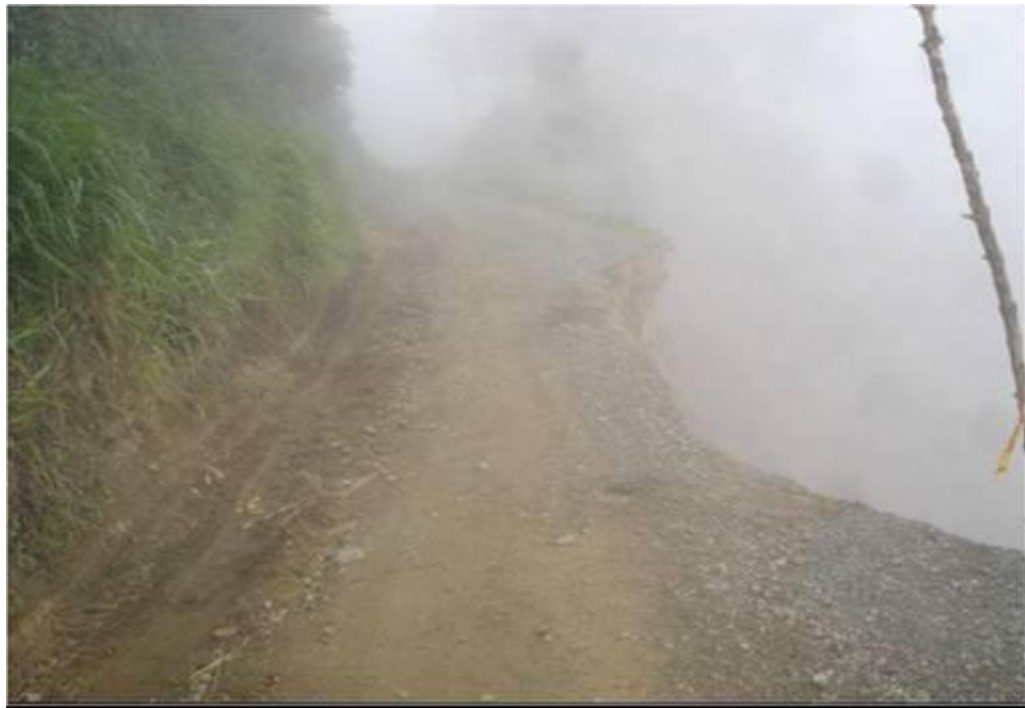
Figura 94. Estado actual de la vía san Bartolomé – municipio de Pácora, Caldas sector El Escobal. Septiembre de 2008. Vía carreteable que conduce de Pácora a San Bartolomé. Municipio de Pácora Vereda San Bartolomé, sector El Escobal.
