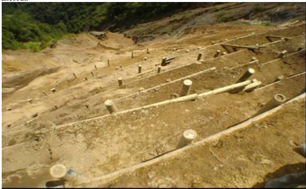
Figura 117. Construcción de trinchos vivos escalonados para estabilizar talud bajo de la vía que conduce de corregimiento San Bartolomé sector el Escobal al municipio de Pácora, Caldas diciembre de 2008. Vía carreteable que conduce de Pácora a San Bartolomé. Municipio de Pácora Vereda San Bartolomé, sector El Escobal.
