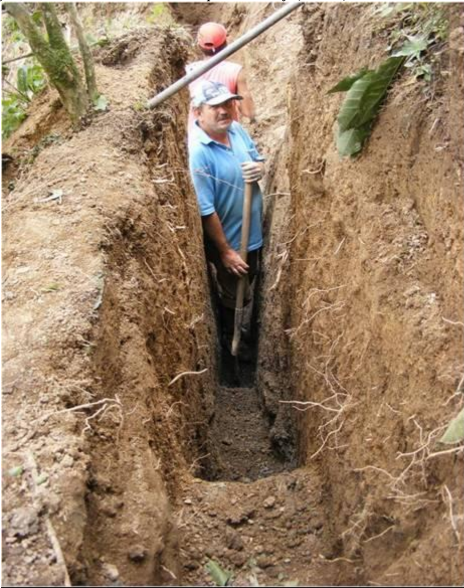
Figura 65. Zanja profunda a través de la pendiente, para empotrar cada uno de los trinchos que sostienen los filtros vivos. Vereda Balmoral municipio de Filadelfia, Caldas, Colombia.
