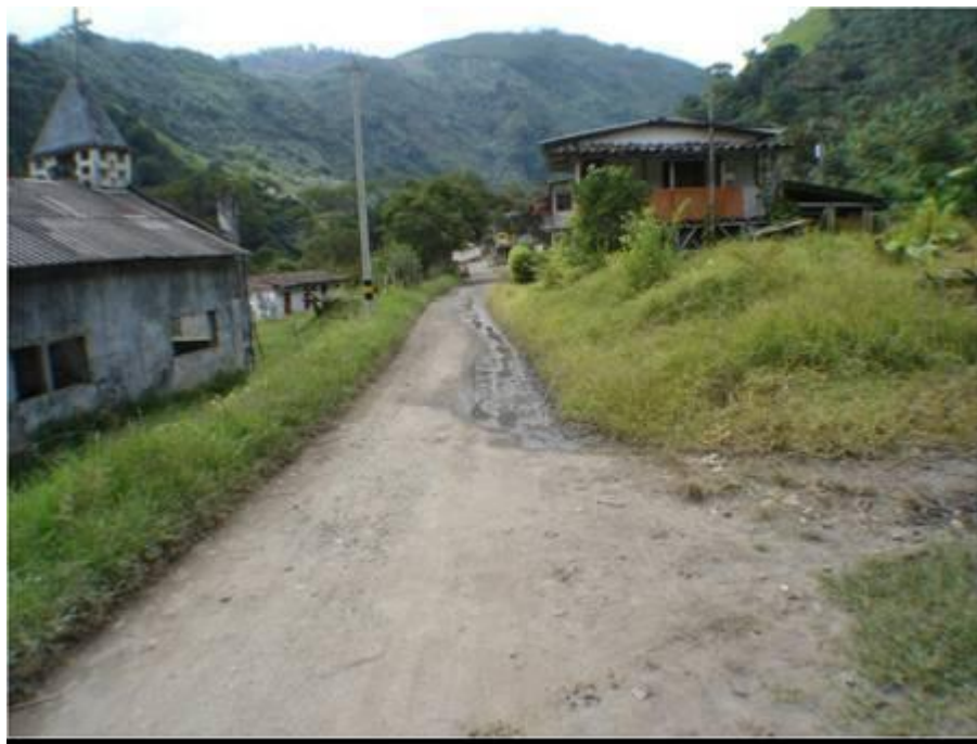
Figura 8. Vereda Rio Claro viejo, Villamaría, Caldas. Julio de 2008. Presencia en la vía de aguas sub-superficiales y ausencia de cunetas evacuadoras de aguas de escorrentía y sub-superficiales (julio de 2008).
