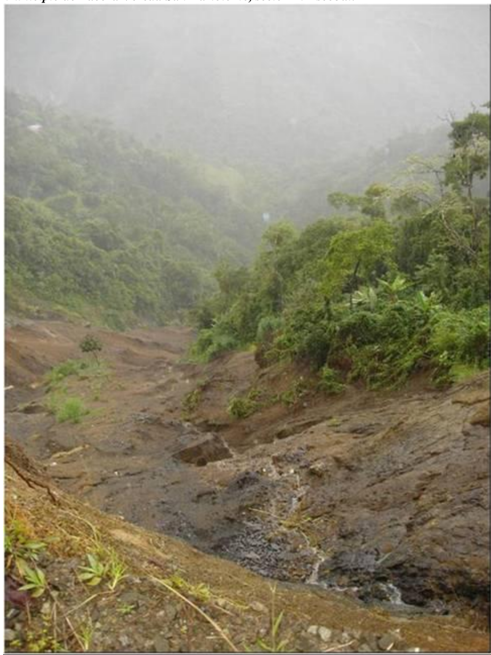
Figura 83. Sitio por donde avanzan las aguas de escorrentía provenientes de la banca de la carretera, acelerando los procesos remontantes. Agosto 10 de 2008. Vía carretable que conduce de Pácora a San Bartolomé. Municipio de Pácora Vereda San Bartolomé, sector El Escobal.
