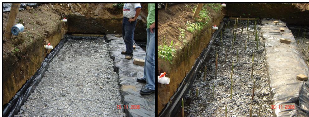
Figura 16. Humedal de Flujo Subsuperficial
