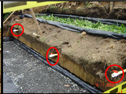
Figura 37. Llaves de paso para evacuación de lodos
