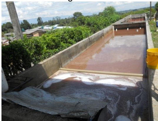
Figura 16. Planta de Tratamiento de Aguas Residuales P.T.A.R.
