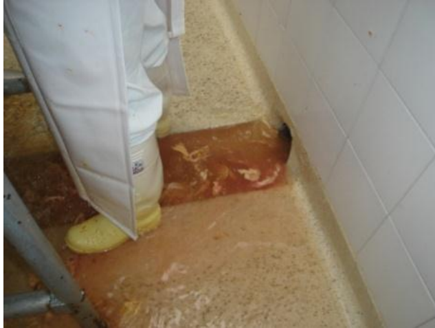
Figura 2. Canalización de residuos líquidos y sólidos provenientes del beneficio
