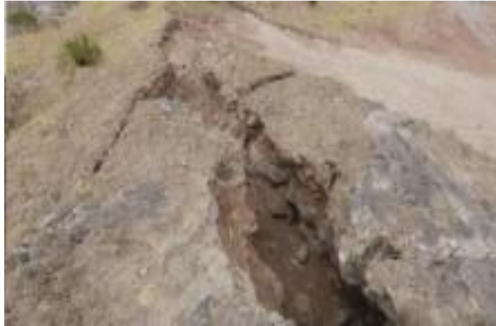
Imagen 4 Presencia de Socavación por inestabilidad en los taludes de corte
