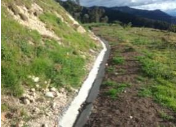
Imagen 5 Cunetas de coronación en concreto
