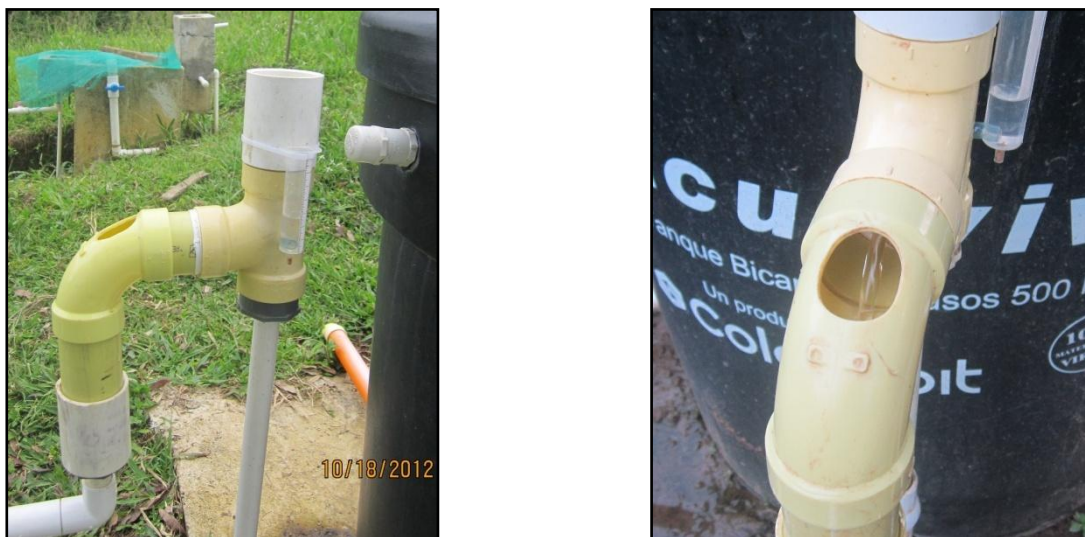
Figura 42. Medición de caudal mediante los vertederos de orificio
