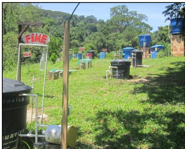
Figura 48. Sistema de bombeo
