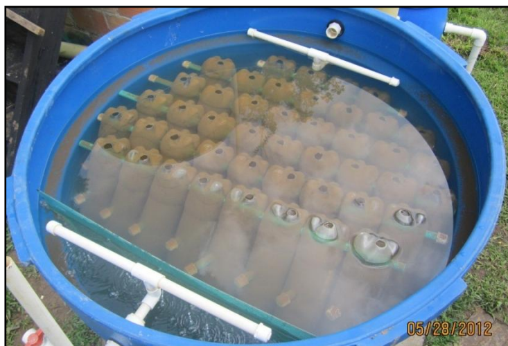
Figura 41. Mantenimiento sedimentador de botellas
