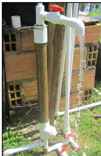
Figura 39. Mantenimiento control de flujo por colmatación
