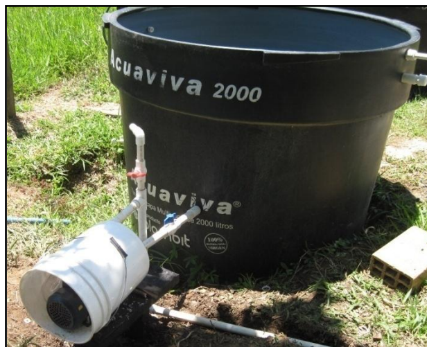
Figura 49. Sistema de bombeo
